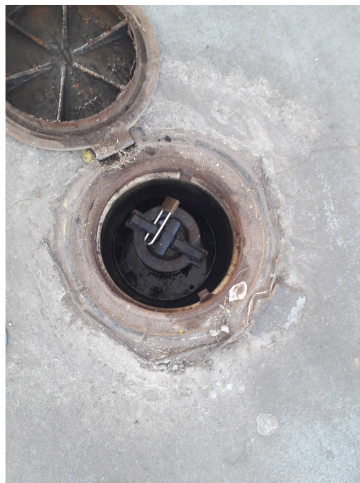
Figura 10. Boca de abastecimento de combustível do tanque
