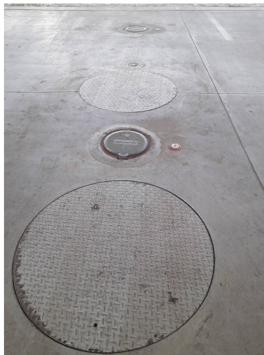
Figura 6. Área de abastecimento e posto de visita dos tanques de combustíveis
