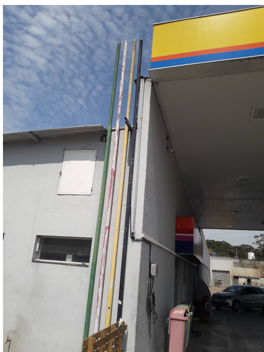
Figura 7. Tubulação de suspiro dos tanques do SASC
