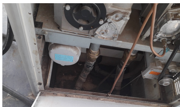
Figura 12. Evidência do sistema de contenção de vazamentos da bomba do SASC
