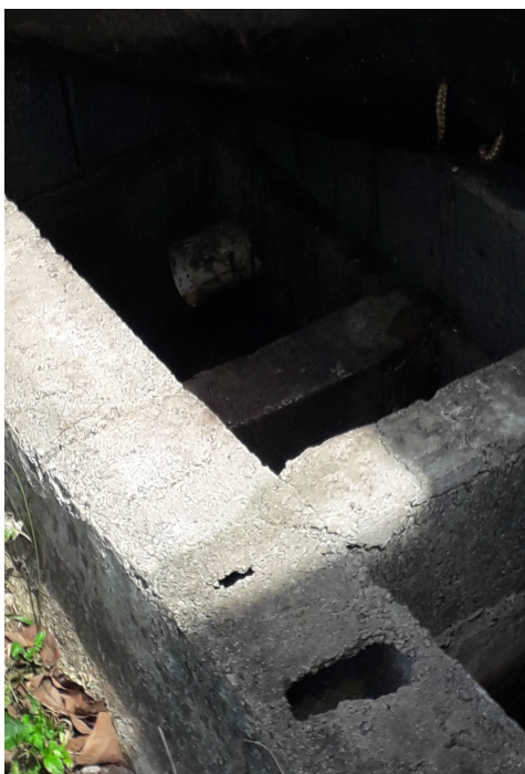
Figura 3. Passagem da Caixa SAO
