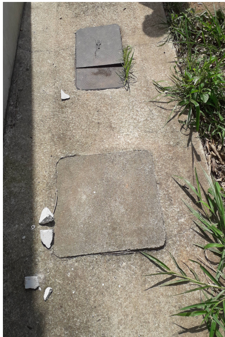
Figura 1. Caixa de gordura e de passagem do sistema de coleta de efluentes das canaletas de contenção
