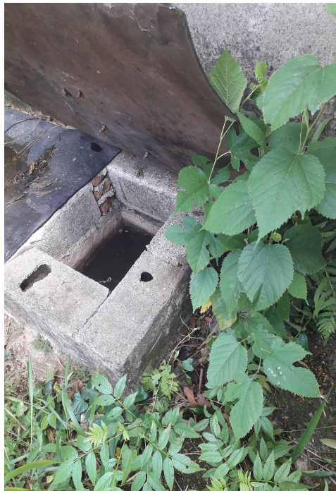
Figura 2. Entrada da Caixa SAO
