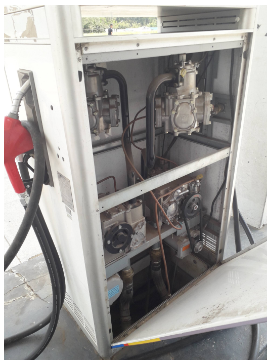
Figura 8. Uma das bombas de abastecimento do SASC.
