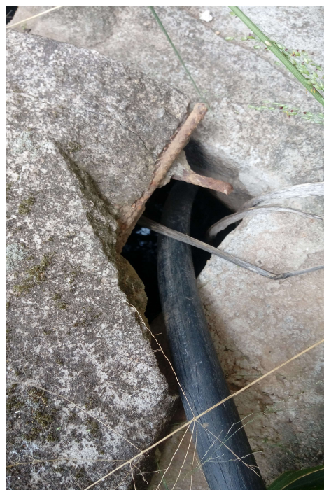
Figura 4. Saída da Caixa SAO no ponto de lançamento na rede coletora
