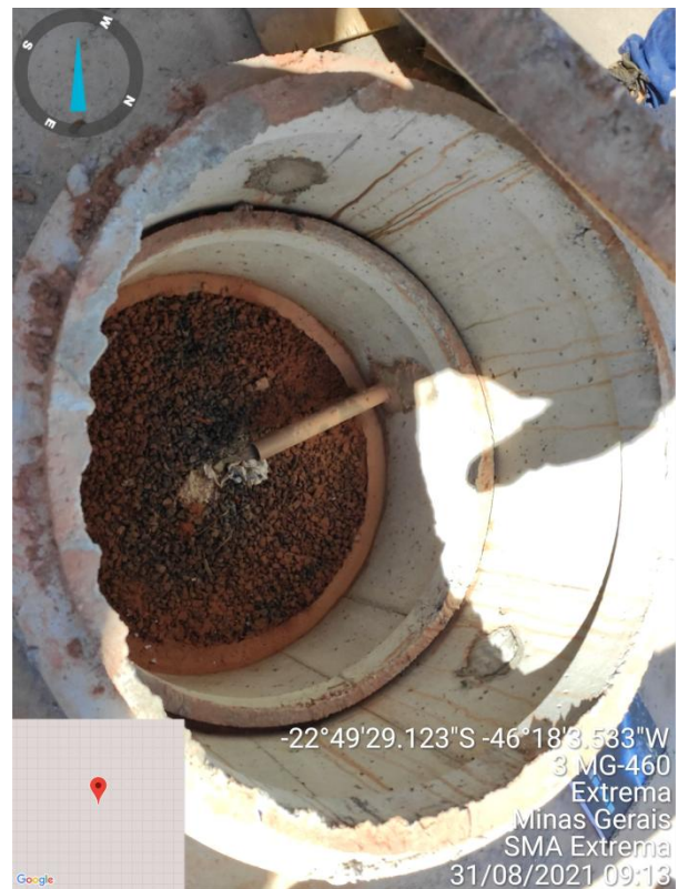
Figura 23 . Sumidouro para lançamento do efluente sanitário tratado
