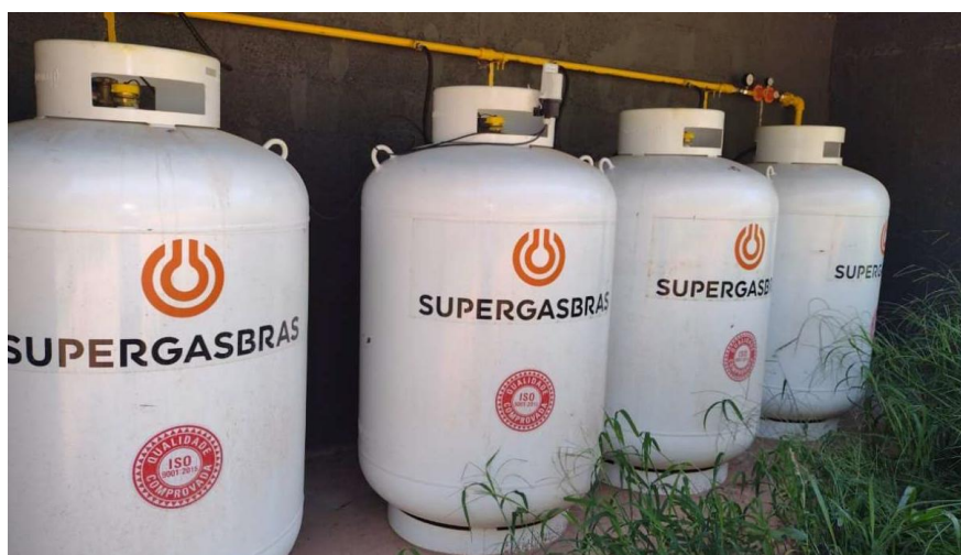
Figura 20. Local de armazenamento de botijões GLP após instalação. (Fonte: Informação complementar)
