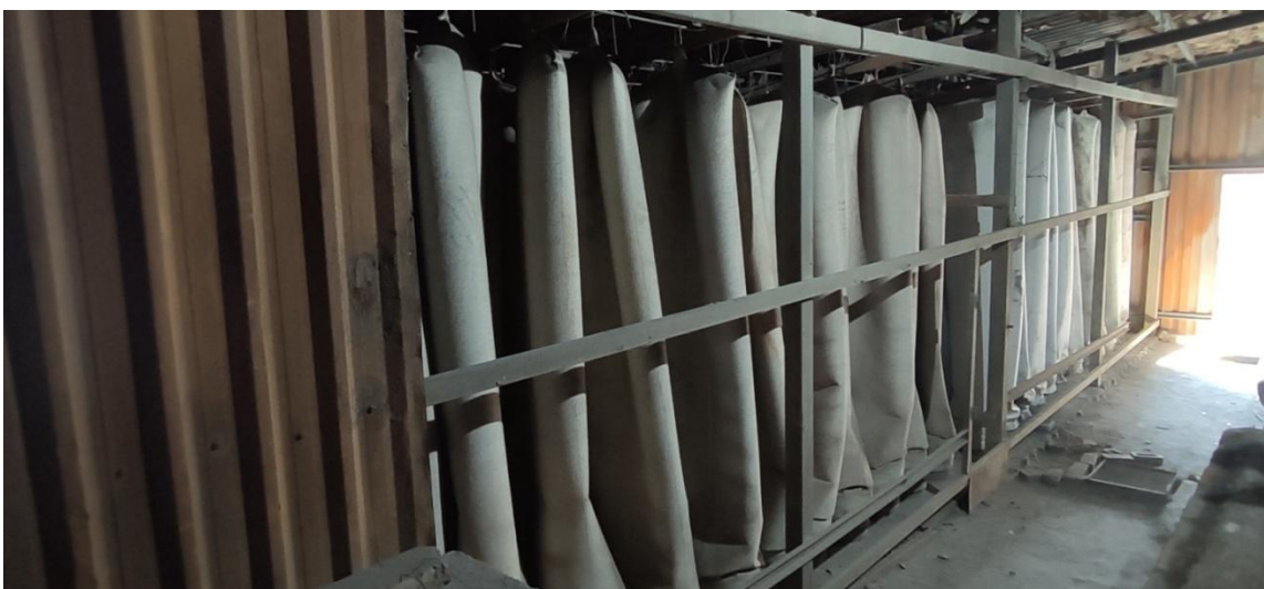
Figura 12. Sistema de despoeiramento (filtro de mangas) do empreendimento.
