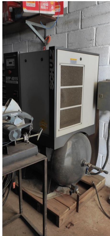
Figura 18. Compressor do empreendimento.
