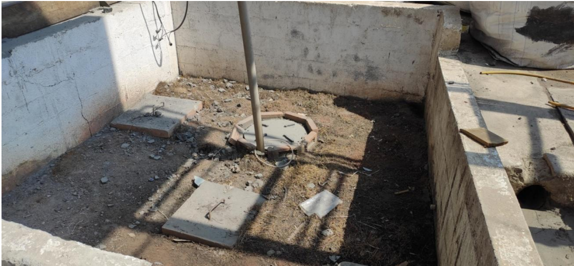
Figura 13. Sistema de tratamento de efluentes sanitários do empreendimento.
