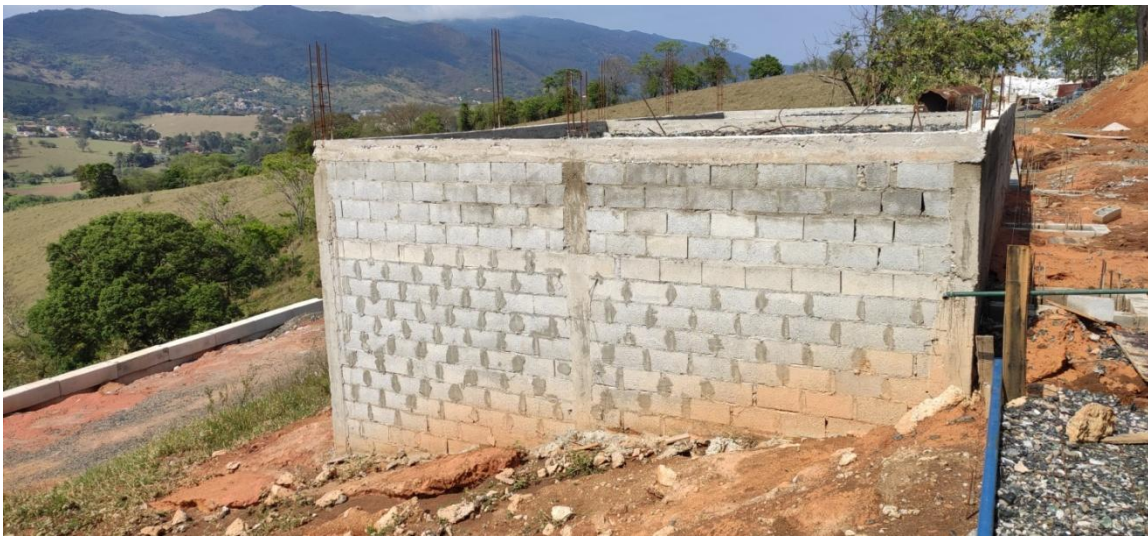
Figura 16. Vista do local de instalação do novo de sistema de despoejamento do empreendimento.
