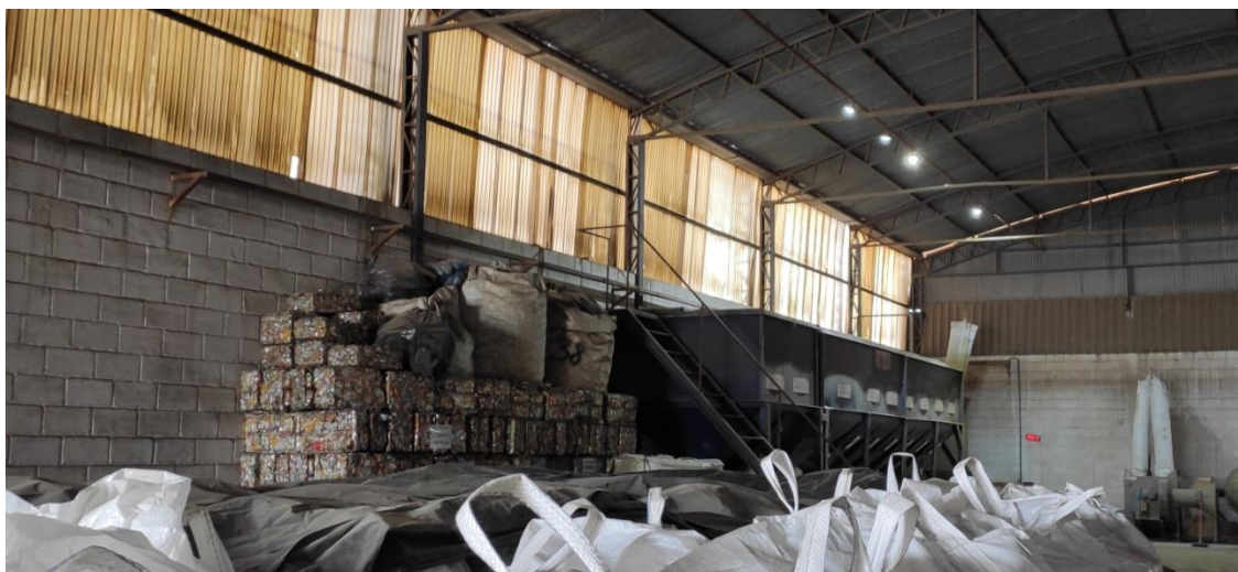
Figura 3. Vista dos equipamentos de formulação e dosagem de matérias-primas.
