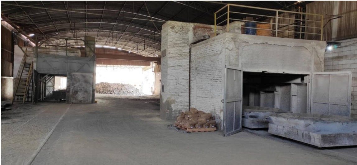
Figura 7. Fornos de indução elétrica do empreendimento.
