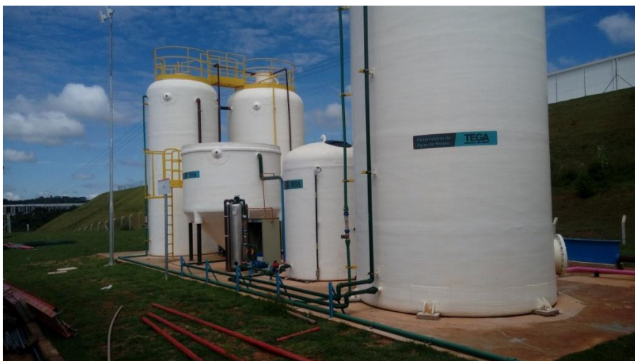
Figura 6. Estação de Tratamento de Efluentes líquidos do condomínio.
