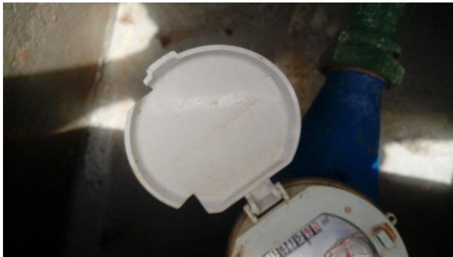
Figura 7. Hidrômetro de captação de água através de poço tubular.
