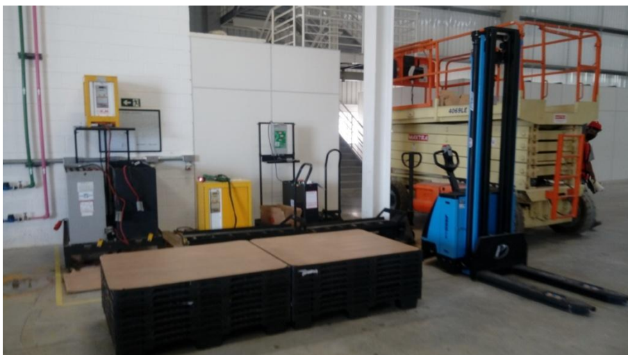
Figura 3. Local de carregamento de baterias.
