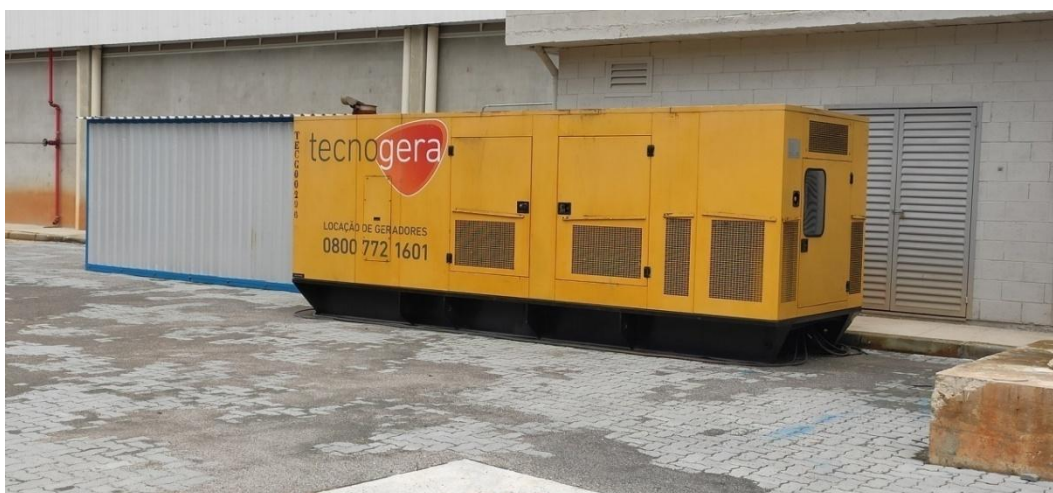
Figura 14. Gerador a diesel para a bastecer o galpão em caso de queda de energia.
