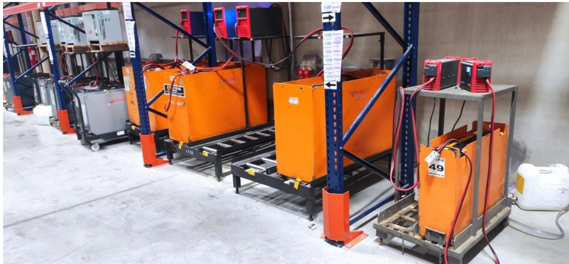
Figura 10. Área de recarga provisória de baterias das empilhadeiras elétricas (2).
