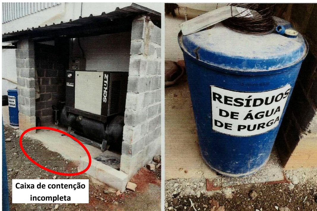
Figura 4. Caixa de contenção construída entorno do compressor e latão de destinação de água de purga.
