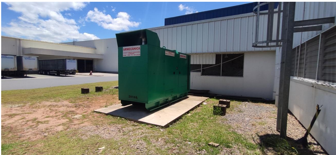
Figura 5. Gerador a diesel localizado na área externa.
