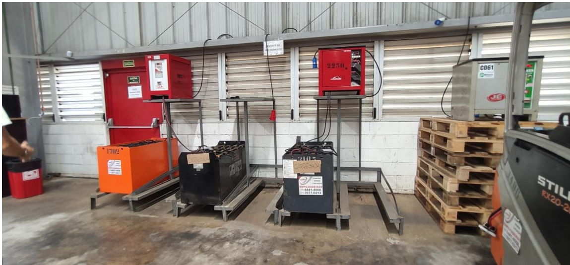
Figura 4. Área de recarga de baterias das empilhadeiras.
