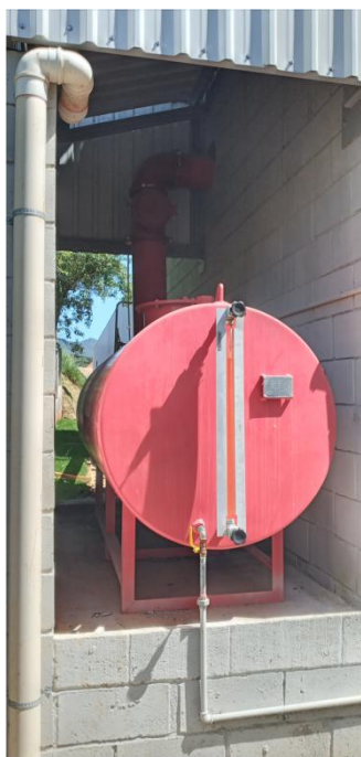
Figura 12. Reservatório de diesel para apoio ao sistema de combate a incêndio do condomínio.
