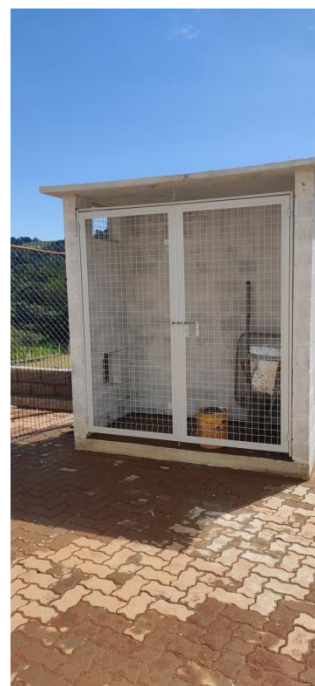
Figura 13. Central de armazenamento de GLP do condomínio.
