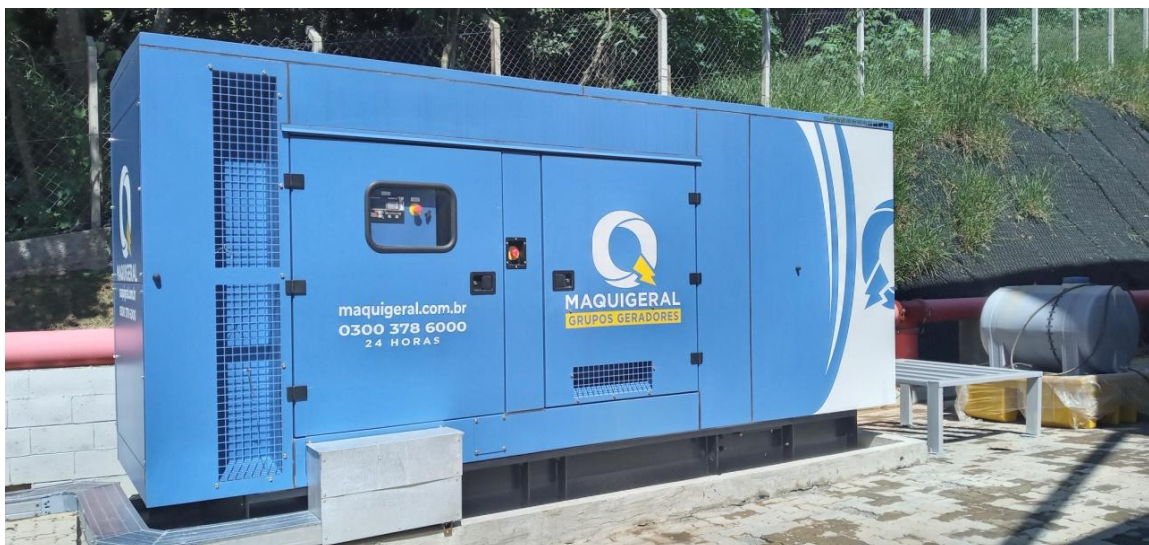
Figura 9. Gerador a diesel para fornecimento de energia ao operador logístico em caso de queda da rede.
