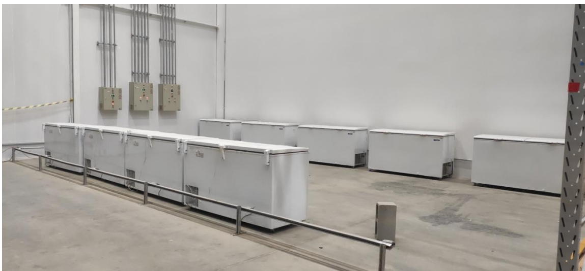
Figura 6. Refrigeradores para armazenamento de produtos farmacêuticos (Chiesi).
