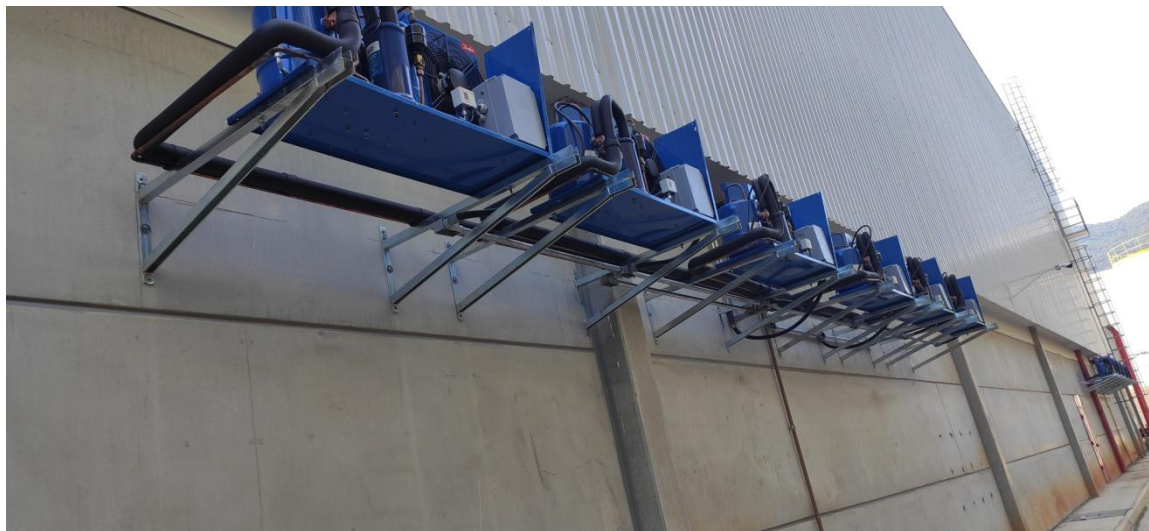
Figura 8. Sistema de resfriamento para apoio à câmara fria e climatização do galpão.
