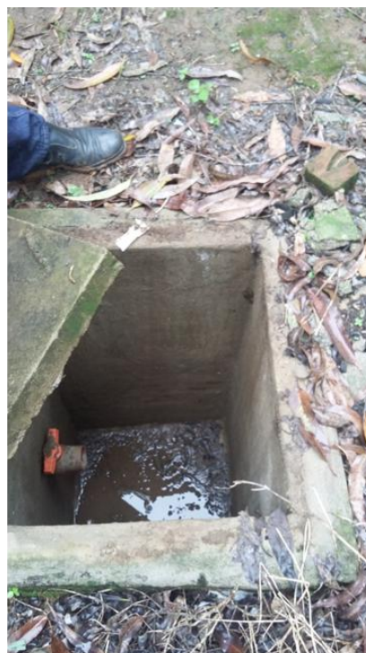
Figura 6. Válvula de limpeza dos biodigestores instalados
