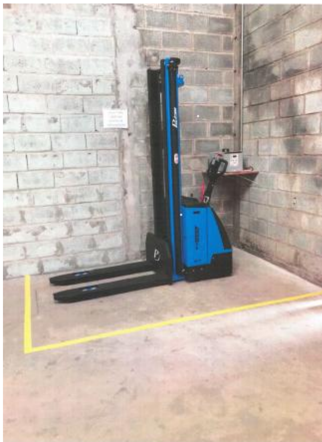
Figura 7.Área de recarga da empilhadeira.
