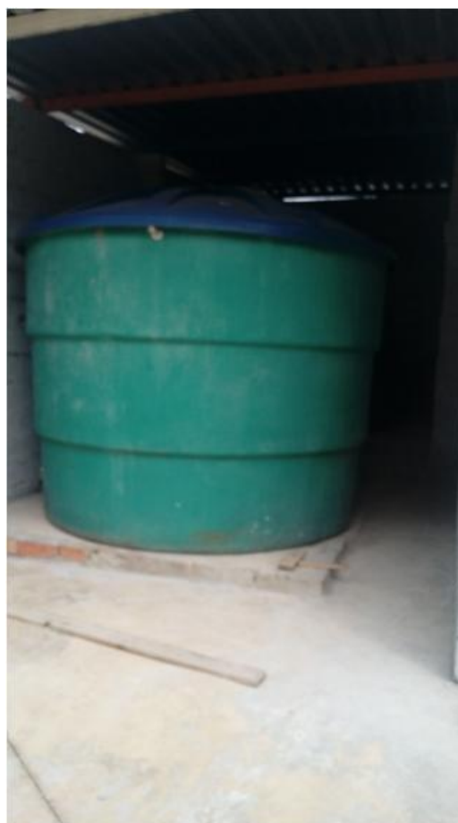
Figura 6. Sistema de contenção em caso de incêndios (12.500L).
