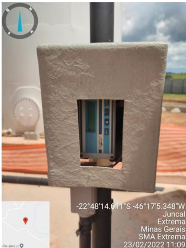
Figura 45. Medidor de vazão da ETE
