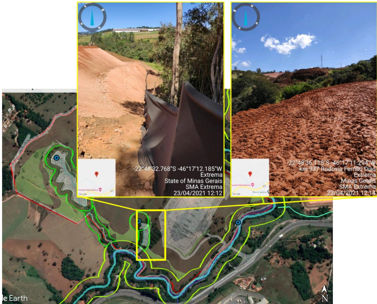
Figura 15. Área de supressão arbórea e terraplenagem autorizada pelo Decreto nº 3.852, de 28/08/2020, e delimitação da APP do córrego local na porção Centro-Sul do empreendimento.
