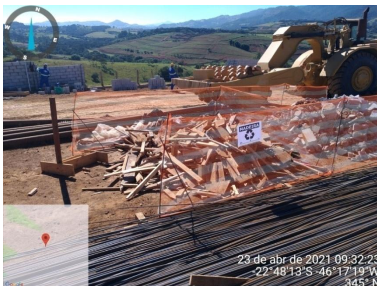
Figura 24. Armazenamento temporário de resíduos da construção civil.
