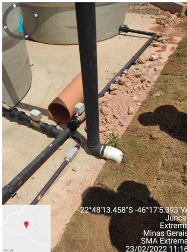
Figura 46. Tubulação de saída ETE - lançamento
