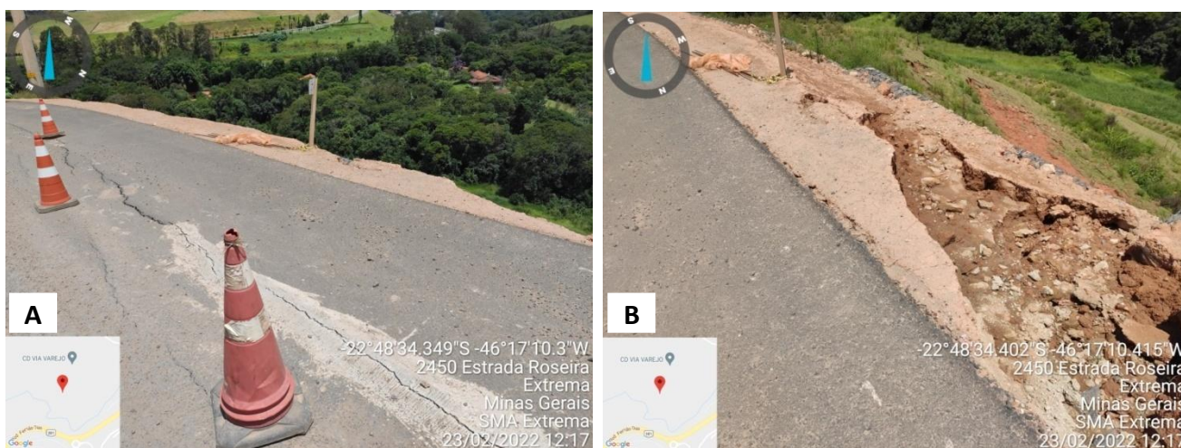
Figura 38. Processos erosivos do talude influenciando a via de acesso interna criada.
