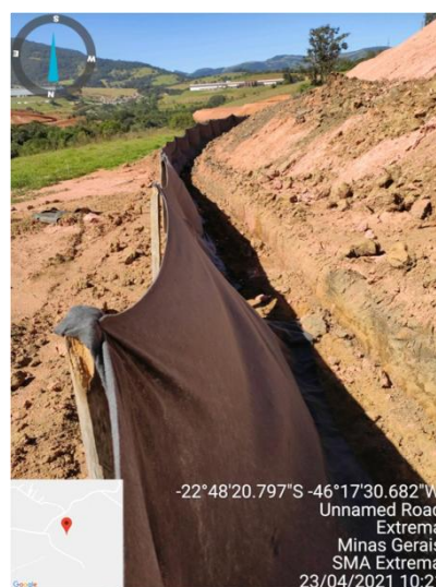
Figura 4. Implantação de cercamento, com manta geotêxtil e vala de contenção em caso de processos erosivos
