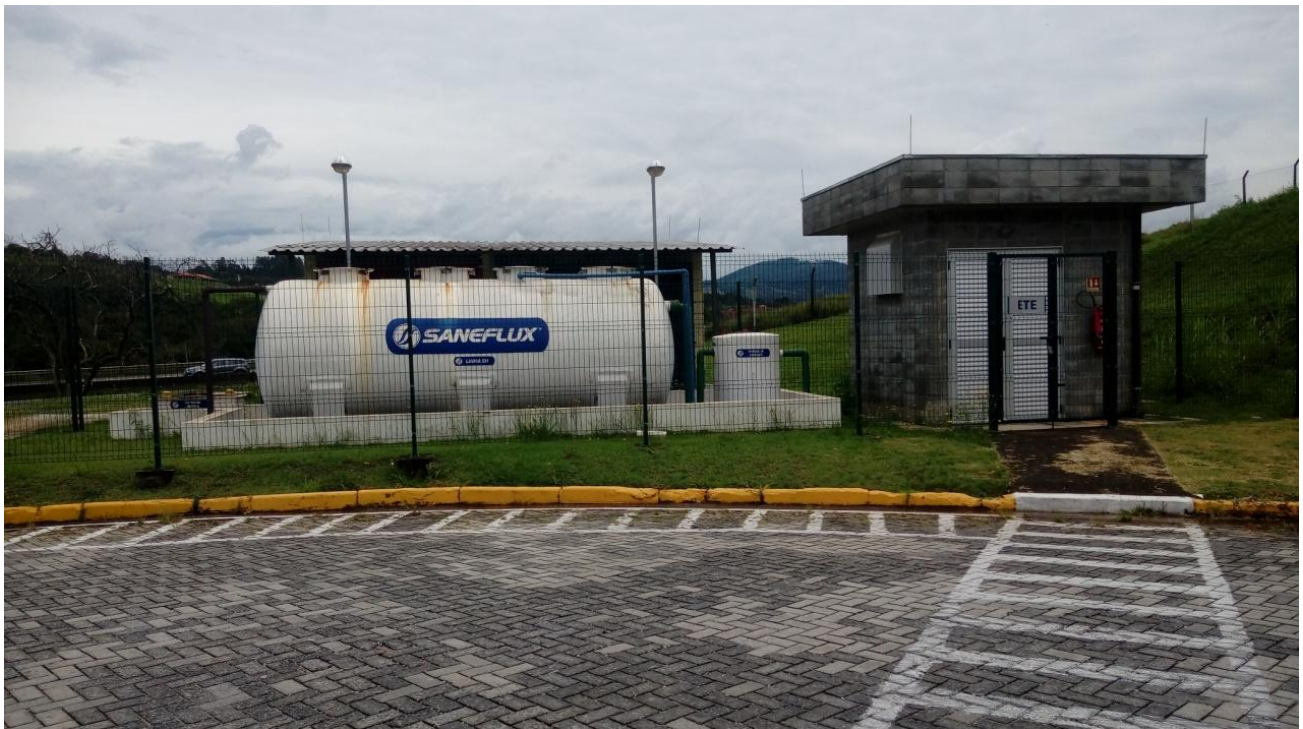
Figura 13. Estação de Tratamento de Efluentes líquidos.
