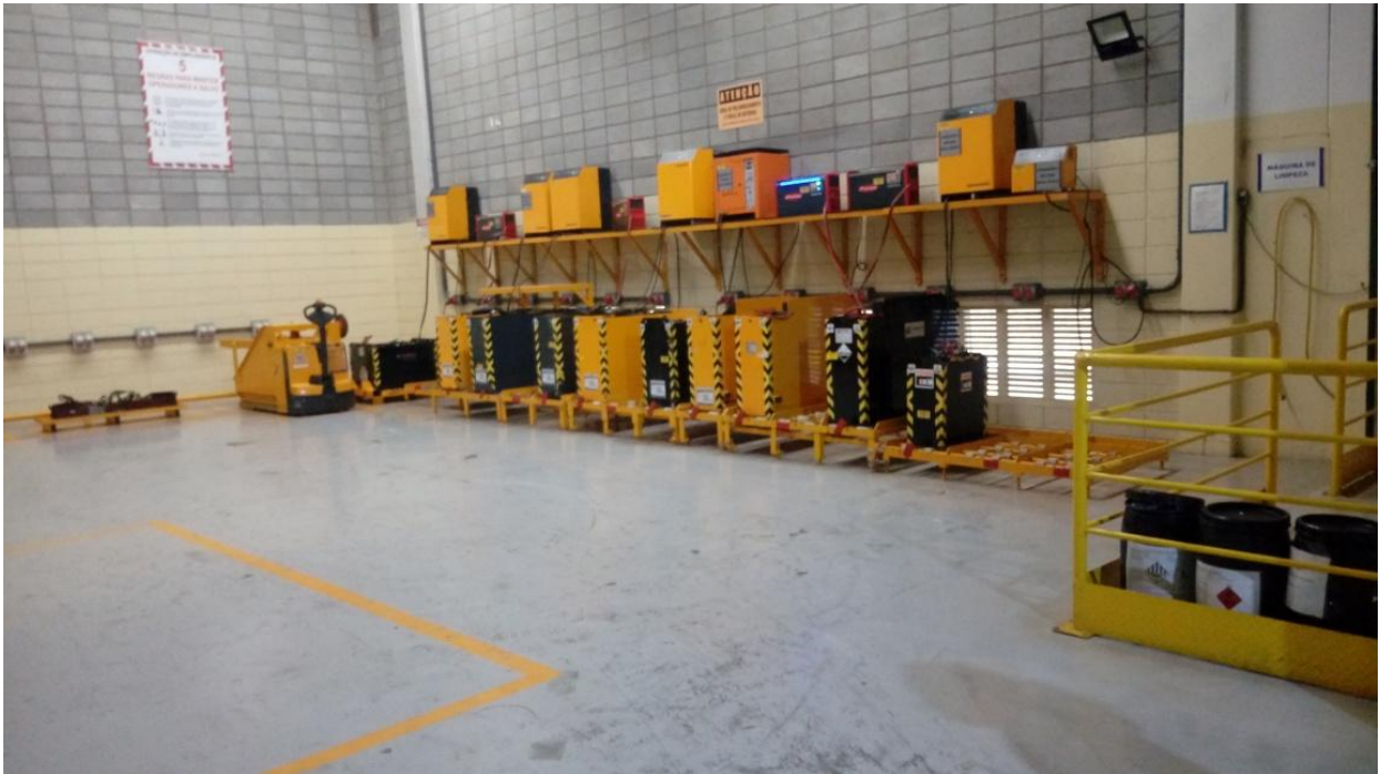
Figura 10. Local de recarga de baterias de chumbo.
