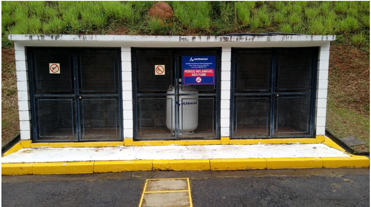
Figura 12. Local de armazenamento GLP.
