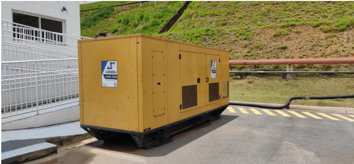
Figura 11. Gerador à Diesel.
