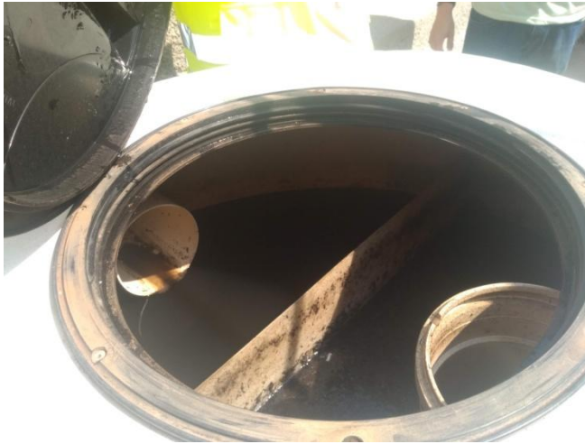
Figura 19. Tanque de contato/desinfecção (ponto de coleta da saída do sistema de tratamento)
