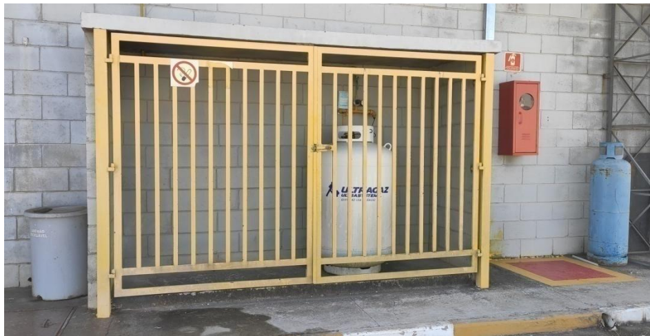
Figura 16. Local de armazenamento GLP 190.
