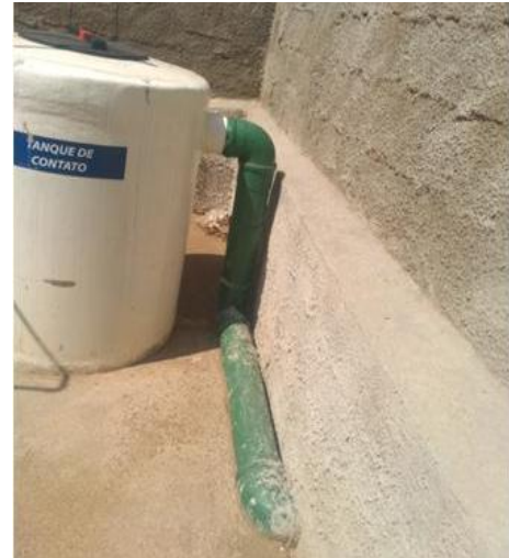
Figura 20. Saída do Efluente tratado para galeria de águas pluviais
