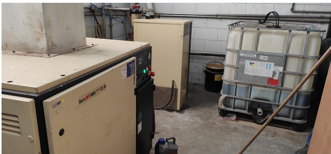
Figura 8. Sala dos compressores.
