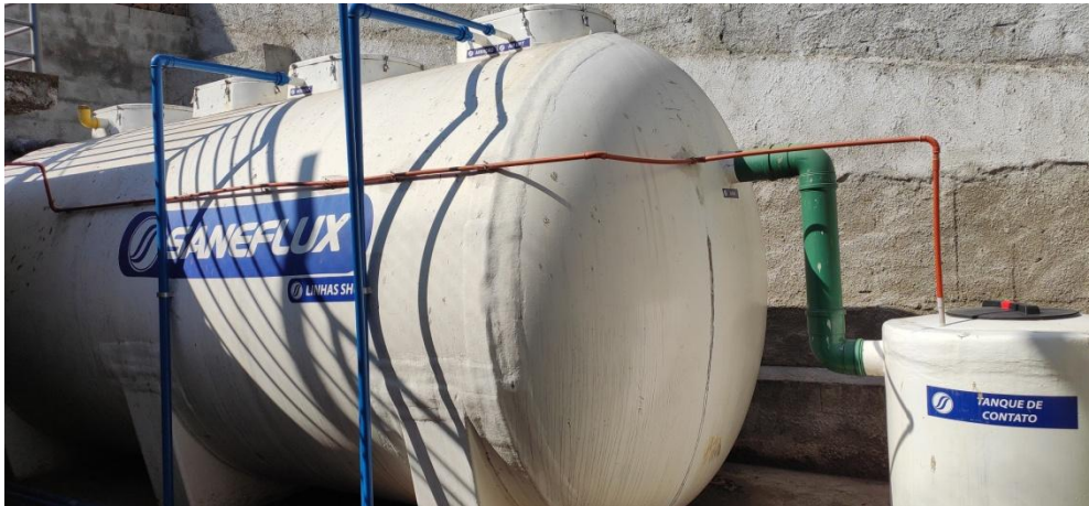
Figura 18. Estação de tratamento de efluentes.
