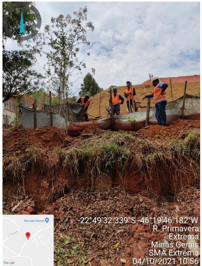
Figura 18. Processo erosivo, com rompimento de manta geotêxtil, na face noroeste, com atividades de reparação em execução
