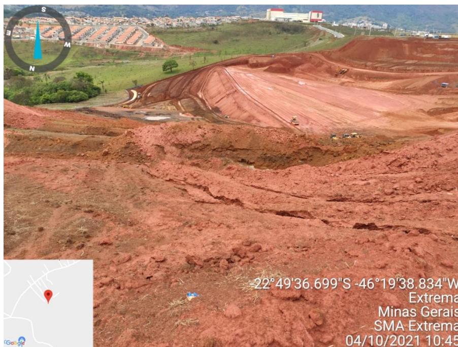
Figura 16. Execução de terraplanagem, com foco em início de processos erosivos durante as obras, contidos pelo tanque de contenção escavado.
