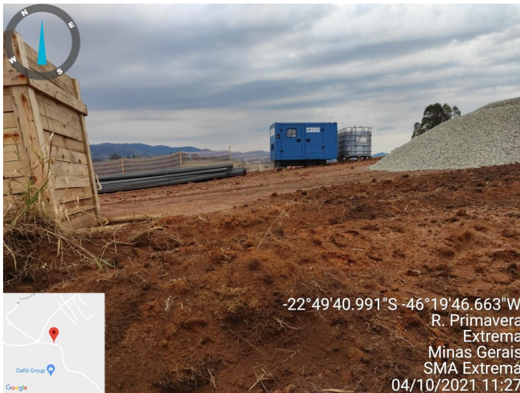
Figura 6. Gerador de energia movido a diesel
