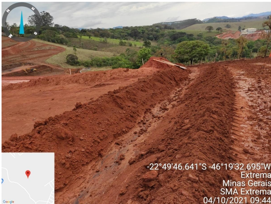
Figura 9. Execução de terraplanagem na face Sudeste do terreno, com destaque para canaleta de direcionamento e contenção de águas pluviais durante as obras.
