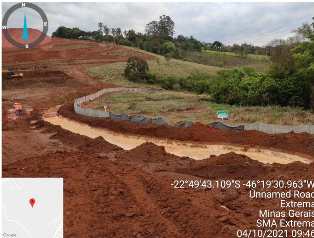
Figura 10. Instalação de manta geotêxtil ao redor do raio da APP da nascente, bem como realização de canaleta de contenção de águas pluviais
