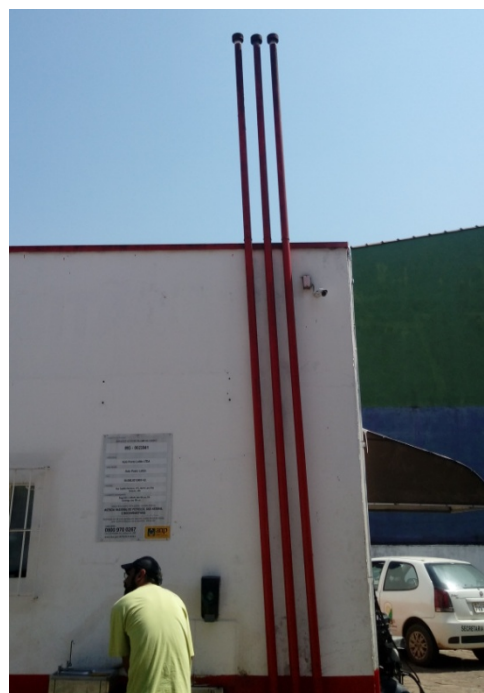
Figura 4. Tubulação de respiração dos tanques do SASC
