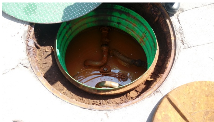
Figura 7. Área de visita do tanque de abastecimento de combustível (etanol)
