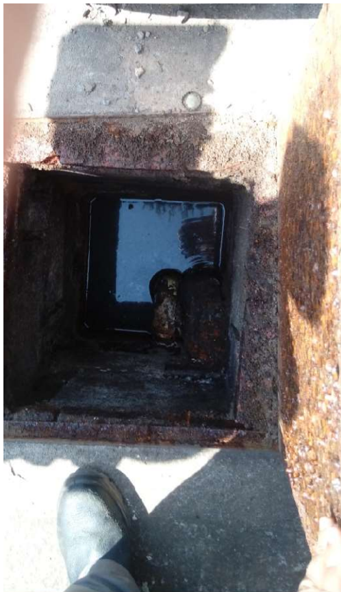
Figura 1. Entrada da Caixa SAO
