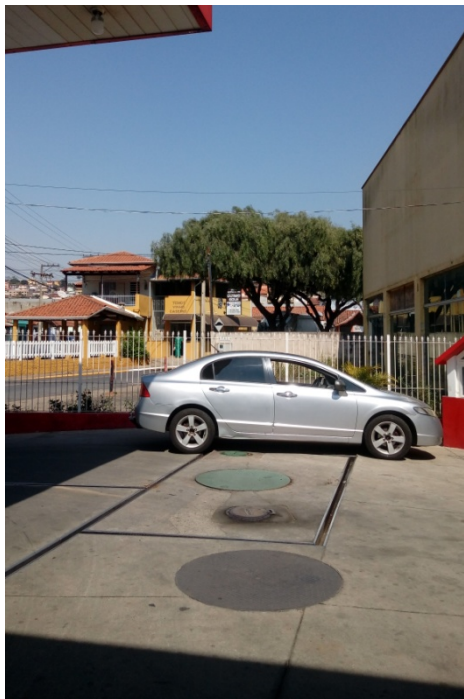
Figura 5. Área de abastecimento e posto de visita dos tanques de combustíveis
