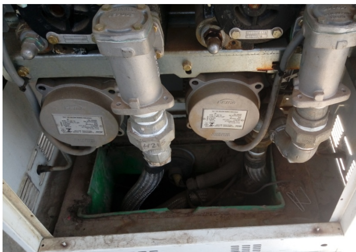
Figura 10. Sistema de contenção de vazamentos da bomba do SASC
