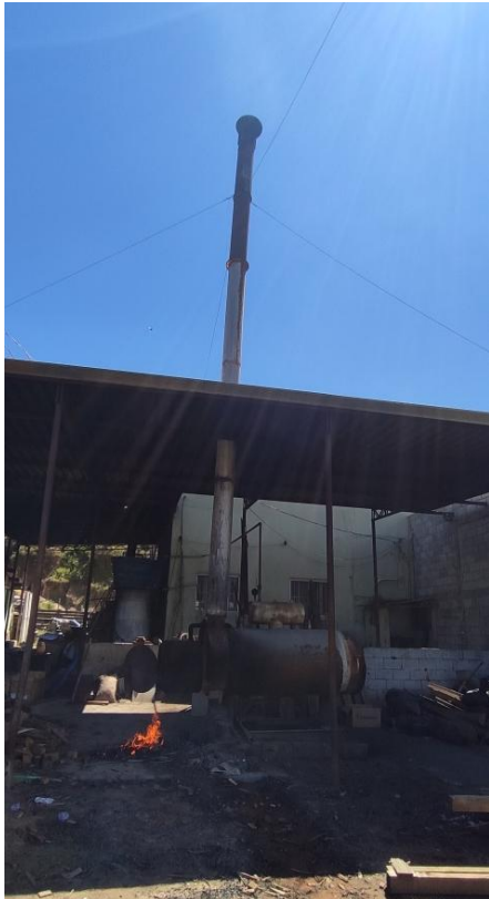
Figura 8. Caldeira com chaminé
