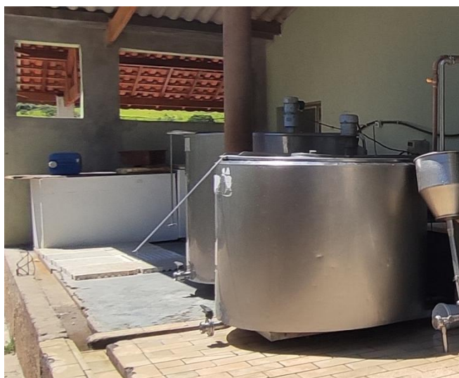
Figura 2. Tanques de fabricação inox (capacidade 1.000 e 800 litros)
