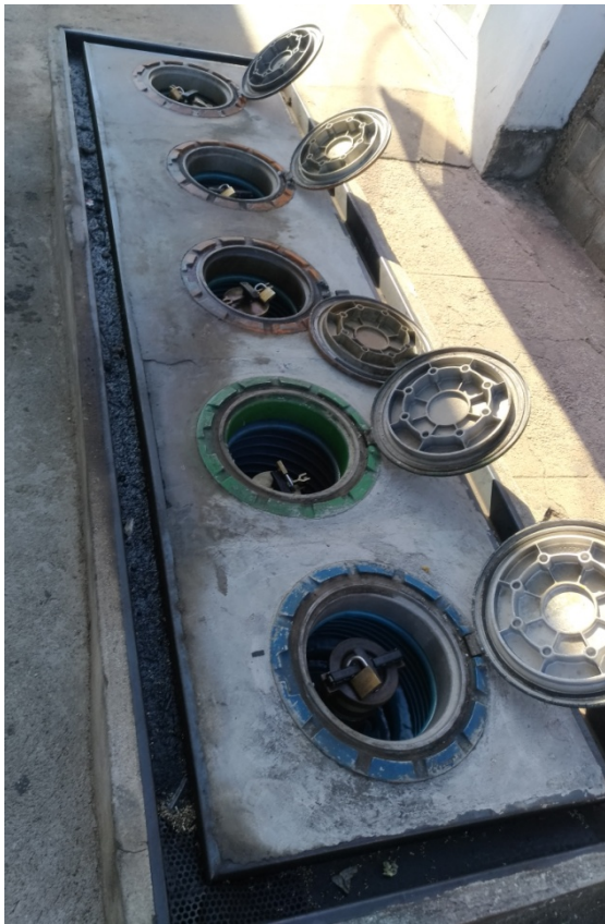
Figura 4. Área de descarga a distância dos tanques subterrâneos de combustíveis
