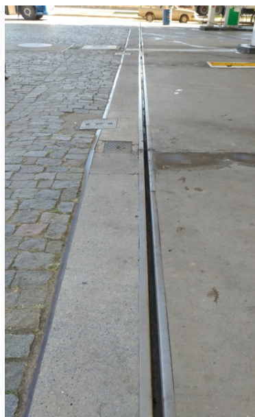
Figura 7. Canaleta de coleta de efluentes ao redor da pista de abastecimento
