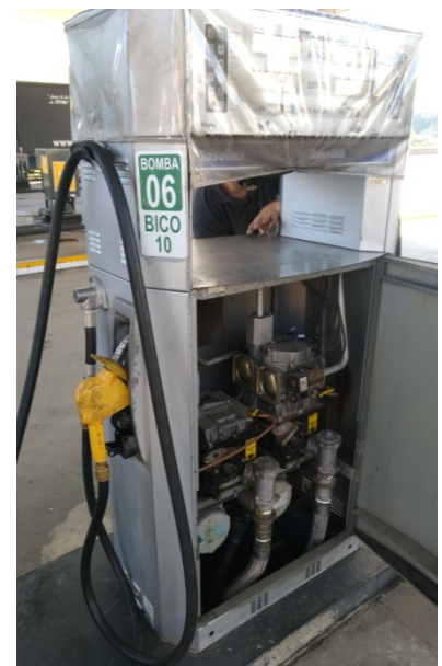
Figura 8. Uma das bombas de abastecimento
