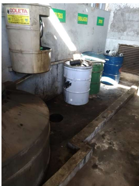
Figura 20. Área de armazenamento de óleos lubrificante, embalagens e EPIs contaminados
