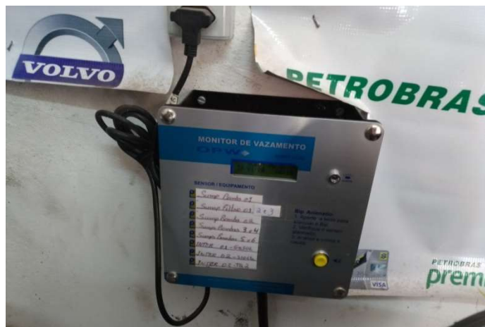
Figura 13. Equipamento de monitoramento intersticial dos tanques
