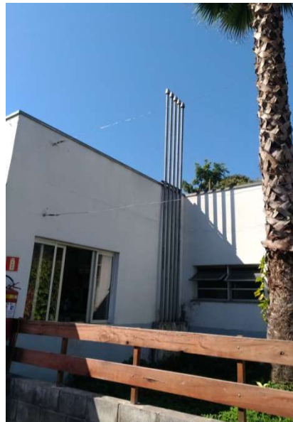
Figura 10. Tubulação de respiro dos tanques do SASC
