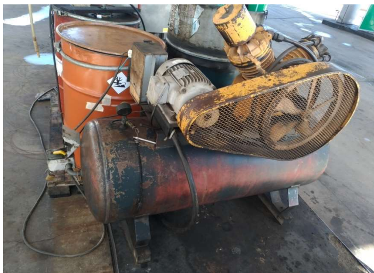
Figura 18. Compressor e tambores de coleta de EPIs e embalagens contaminadas com óleos e graxas
