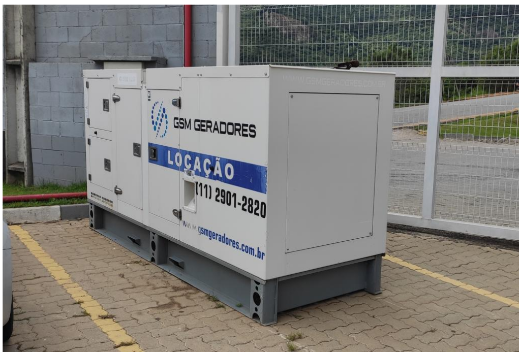
Figura 10. Gerador de energia.
