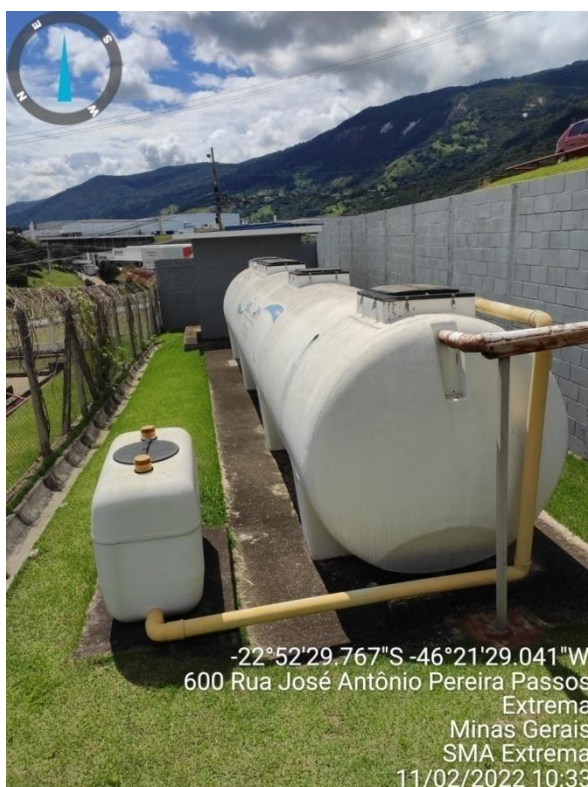
Figura 11. Estação de Tratamento de Efluentes sanitários
