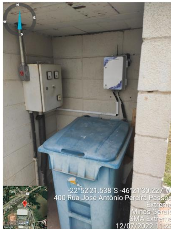
Figura 23. Sistema de relógio e horímetro do bombeamento do poço tubular
