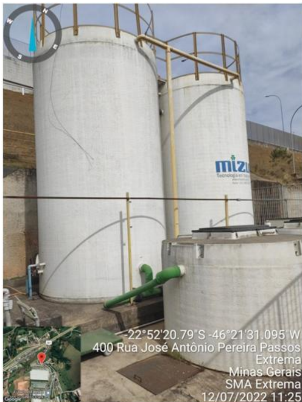
Figura 20. ETE - Estação de Tratamento de Efluentes sanitários
