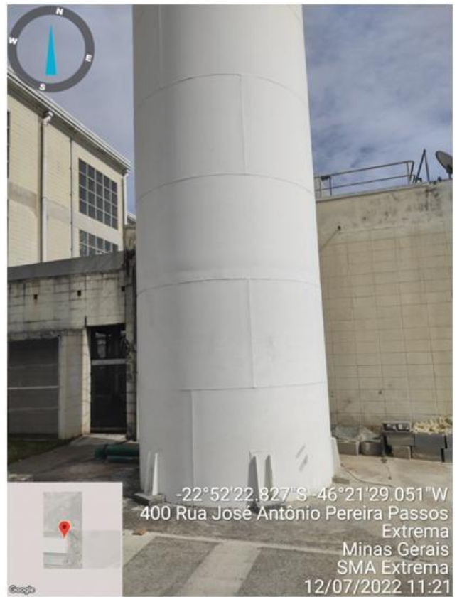
Figura 19. Tanque contenção e combate a incêndio
