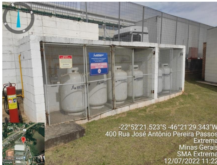
Figura 13. Local de armazenamento de GLP para suporte a produção de alimentos
