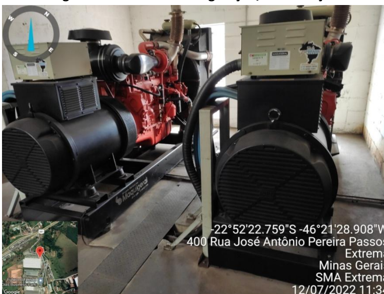
Figura 15. Área dos geradores
