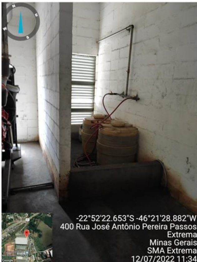
Figura 18. Bombonas de passagem de combustível (alimentação dos geradores)
