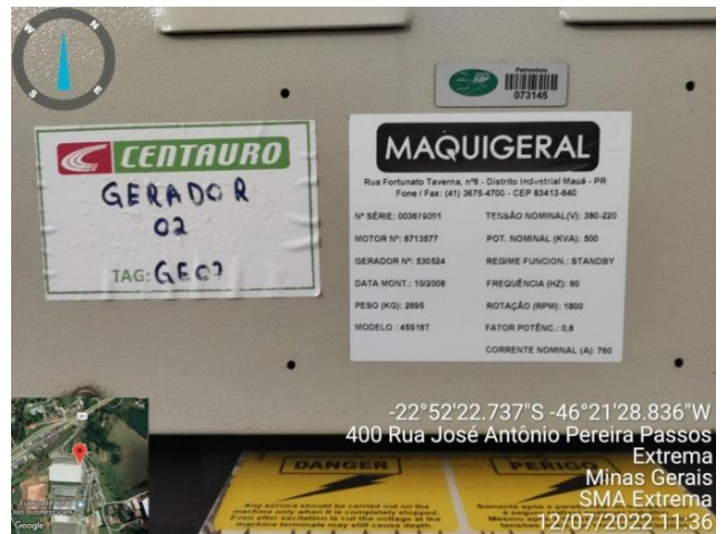
Figura 17. Gerador à diesel 02
