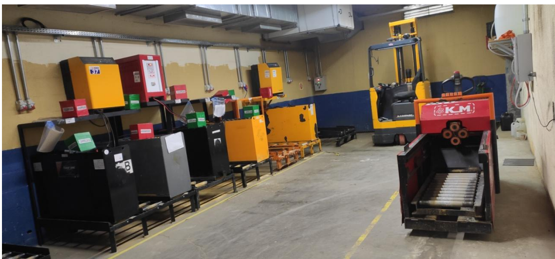
Figura 8. Sala de baterias
