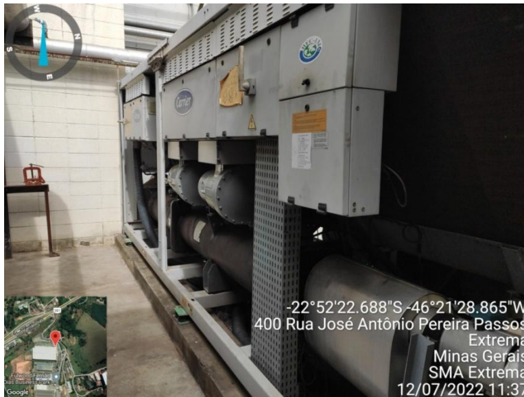
Figura 14. Chillers de refrigeração/climatização
