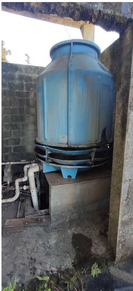
Figura 13. Torre de resfriamento
