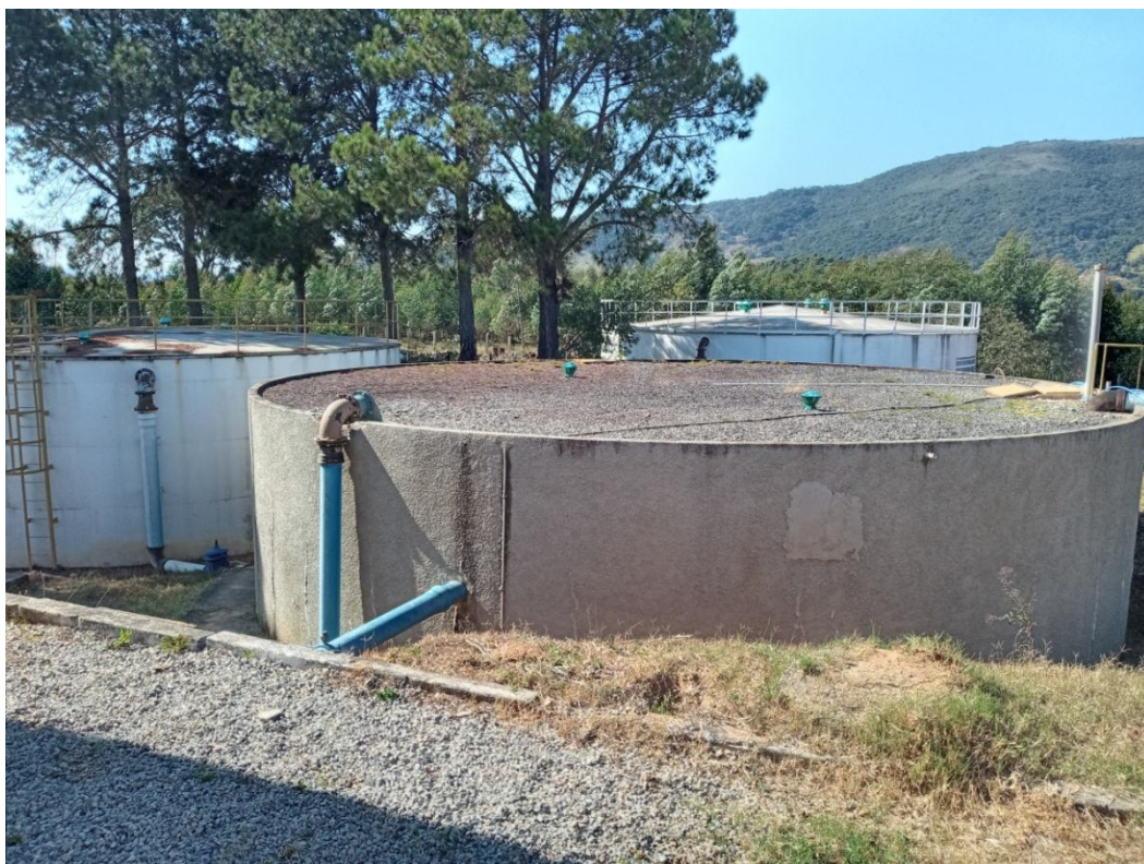
Figura 11. Tanques reservatórios de água tratada
