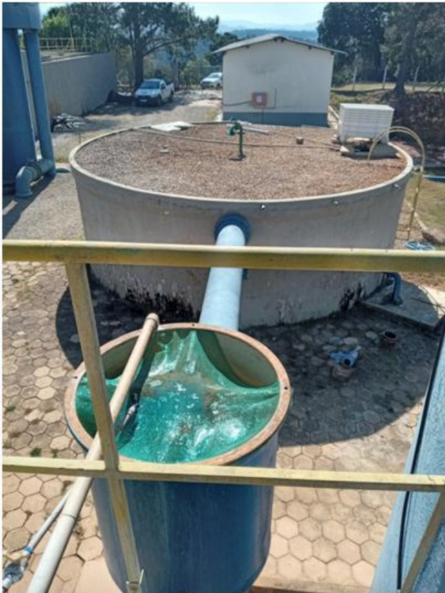
Figura 9 . Tanque de Contato
