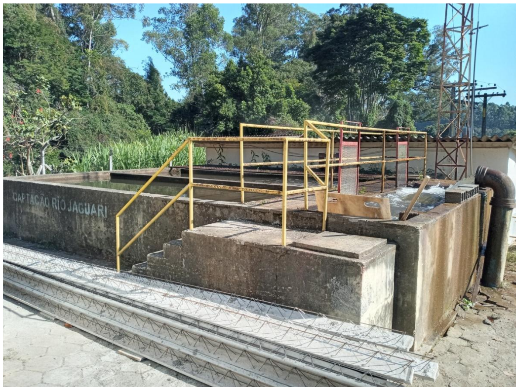
Figura 2 . Caixas de Decantação EEAB - ETA Jaguari
