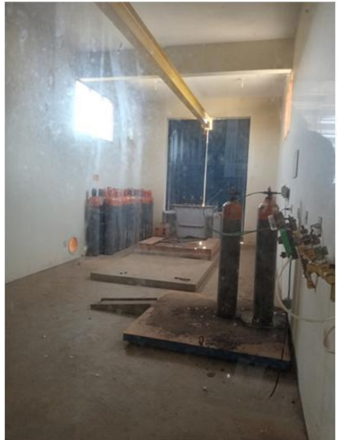
Figura 10. Casa de gás
