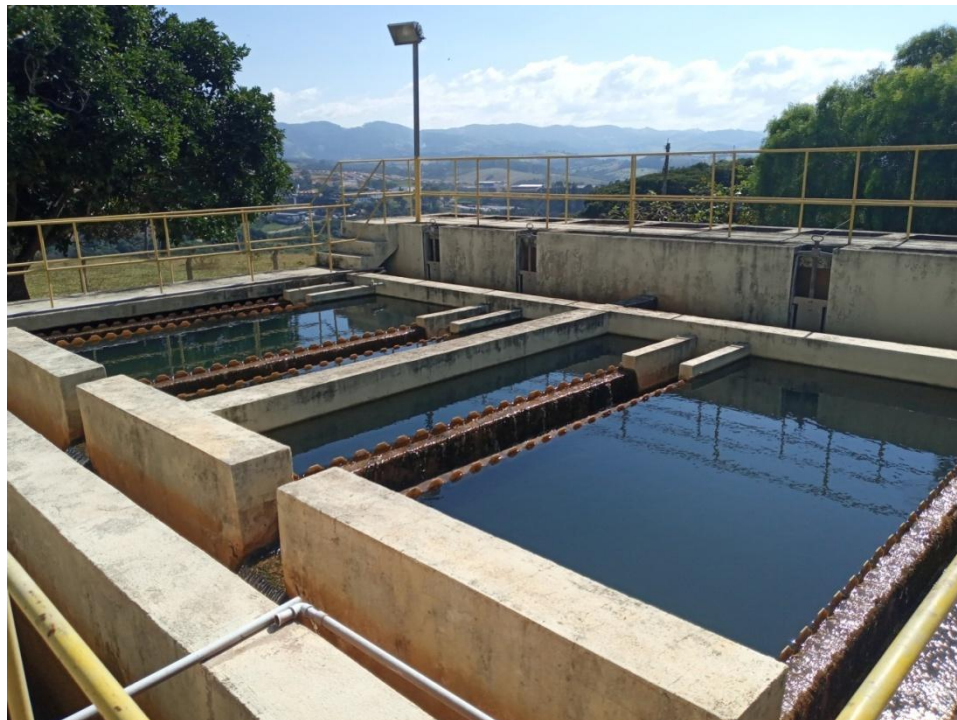
Figura 4 . Sistema de tratamento ETA Jaguari I
