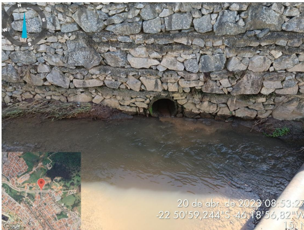
Figura 14. Ponto de lançamento de águas residuárias da ETA Jaguari I e II, localizado na Av. Lavapés (em frente ao antigo Batalhão da Polícia Militar)
