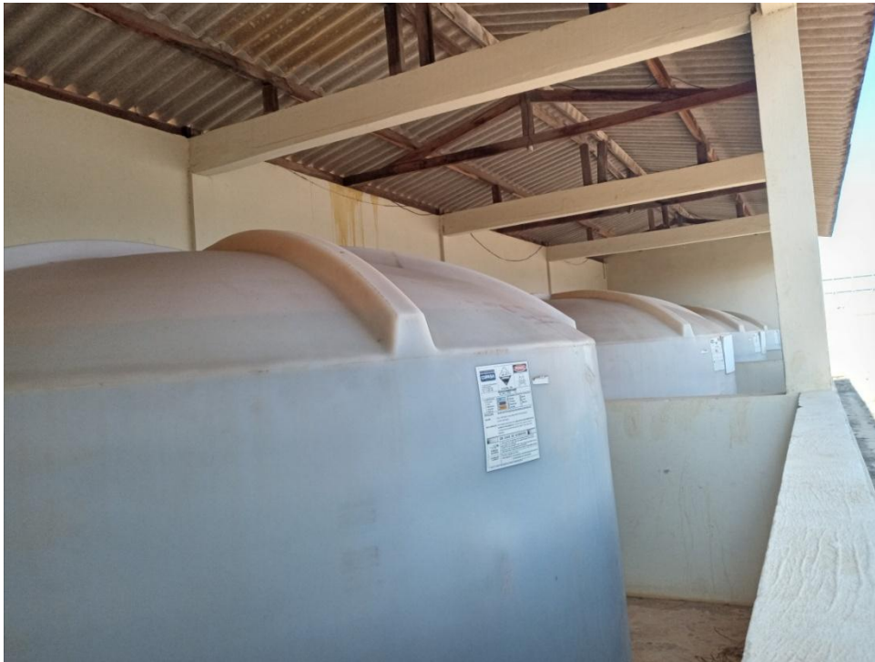
Figura 12. Câmara de estoque de produtos químicos
