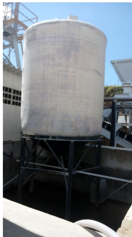
Figura 4. Tanque de aditivo.
