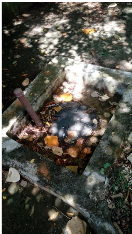
Figura 5. Local de instalação do biodigestor.
