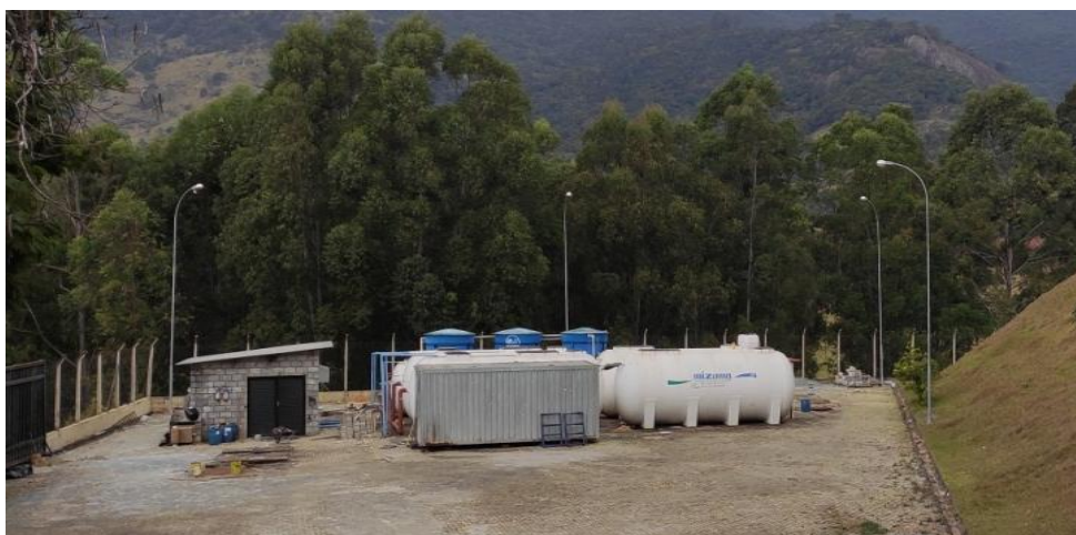
Figura 6. Vista da ETE do empreendimento
