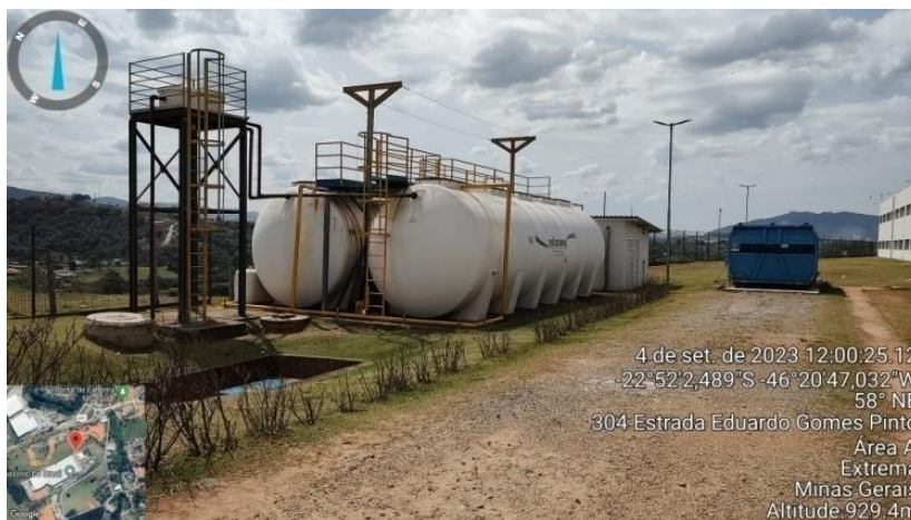
Figura 21. Estação de Tratamento de Esgoto – ETE existente e caçamba compactadora de lixo orgânico
