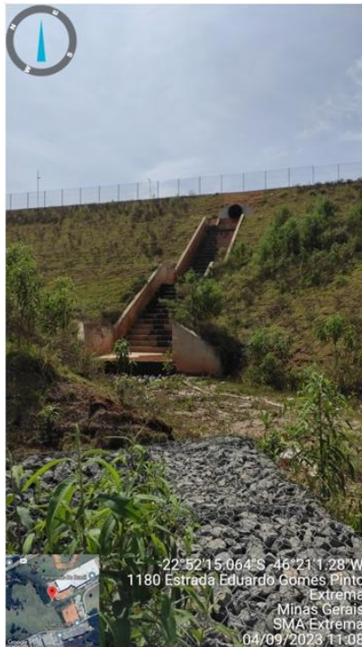
Figura 23. Escada hidráulica do lançamento do Sistema de Drenagem Pluvial instalado para ampliação
