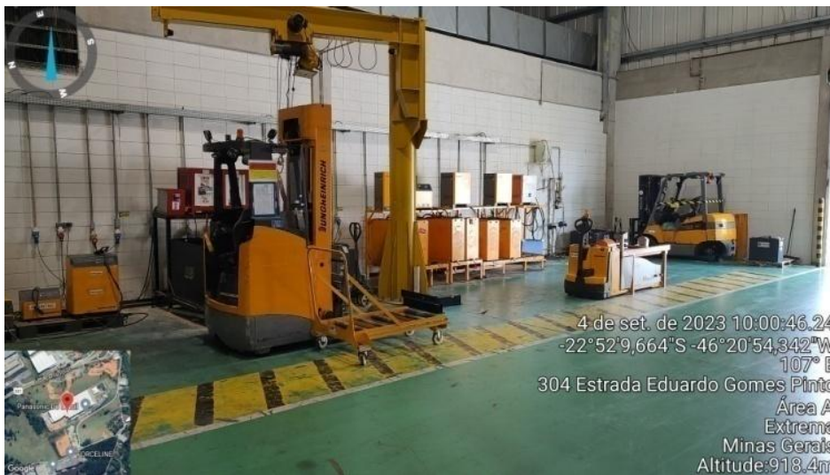
Figura 10. Ponto de recarga de empilhadeiras com baterias elétricas
