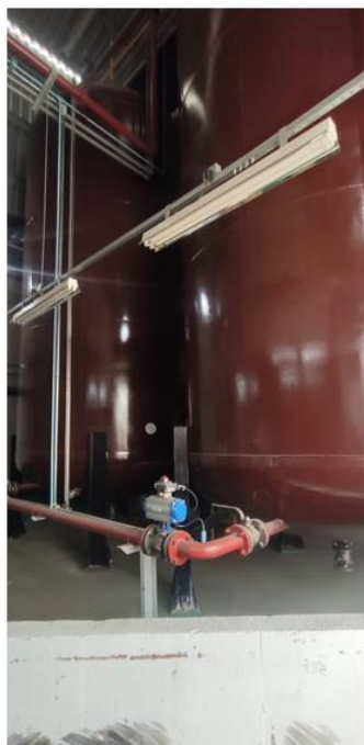
Figura 14. Tanques de poliuretano
