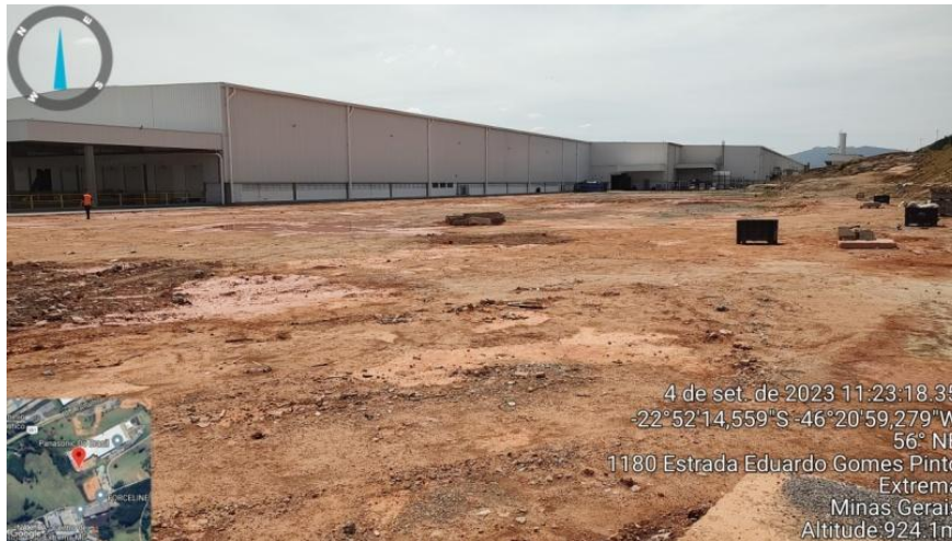
Figura 1. Vista da ampliação do galpão. A frente área para instalação da Portaria III e estacionamento de carretas
