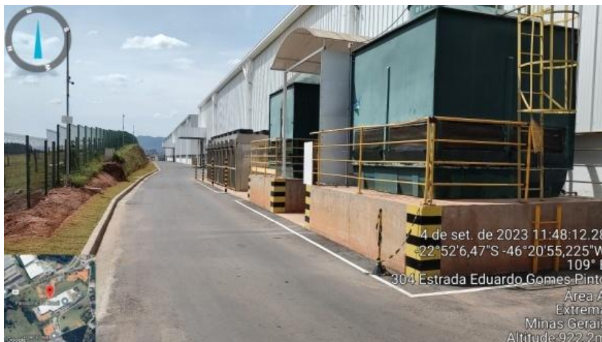
Figura 3. Área de ampliação – expansão lateral, com realocação de torres de resfriamento e chillers.
