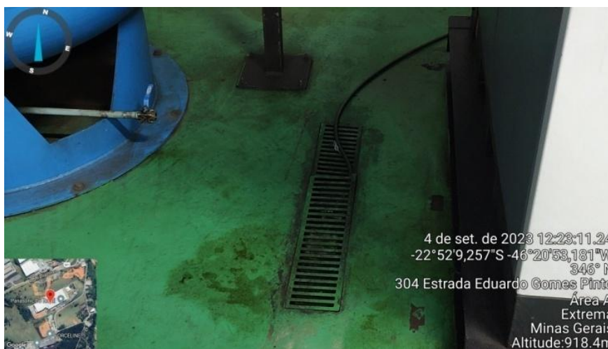
Figura 17. Calha onde é despejado o efluente dos compressores (água de purga)
