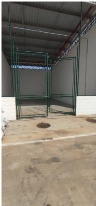
Figura 18. Nova Area de armazenamento de resíduos Classe 1
