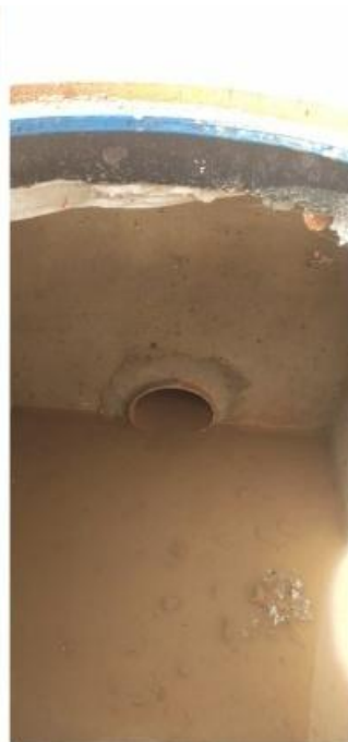
Figura 20. Tanque de contenção em caso de vazamento de resíduos Classe 1
