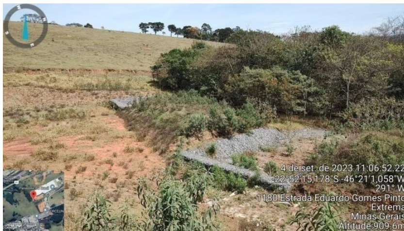
Figura 24. Tanque de retardo do de águas pluviais com 2 saídas em rachão (a frente recebe maior parte da vazão para APP)
