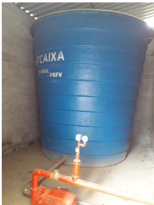
Figura 2. Reservatório de água para combate a incêndio
