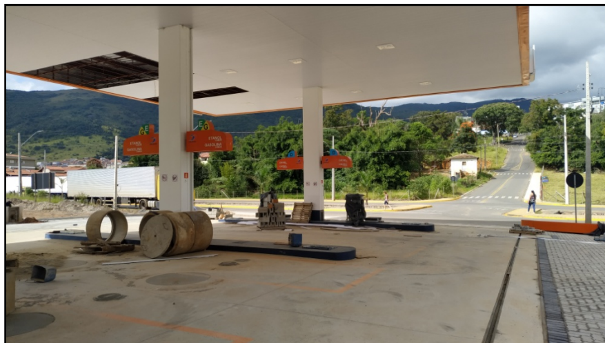
Figura 2. Vista interna da pista de abastecimento, evidenciando a instalação de canaletas de contenção.
