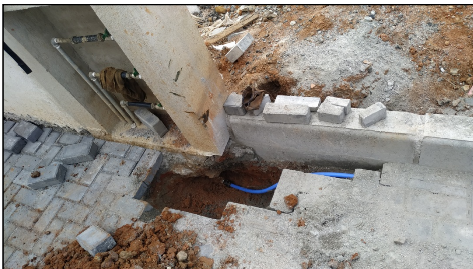
Figura 8. Ligação de água do empreendimento.
