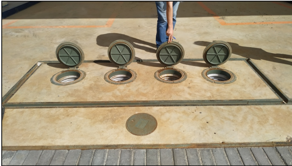
Figura 6. Bocas de descarga dos tanques de combustíveis. Da esquerda para a direita: gasolina, diesel S10, diesel S500 e etanol.
