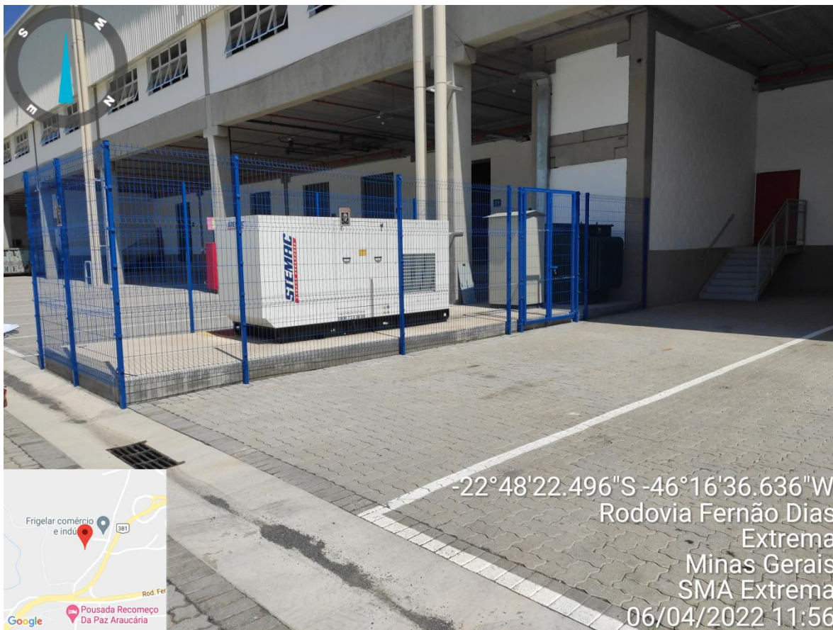
Figura 16. Gerador a diesel para abastecer o galpão em caso de queda de energia
