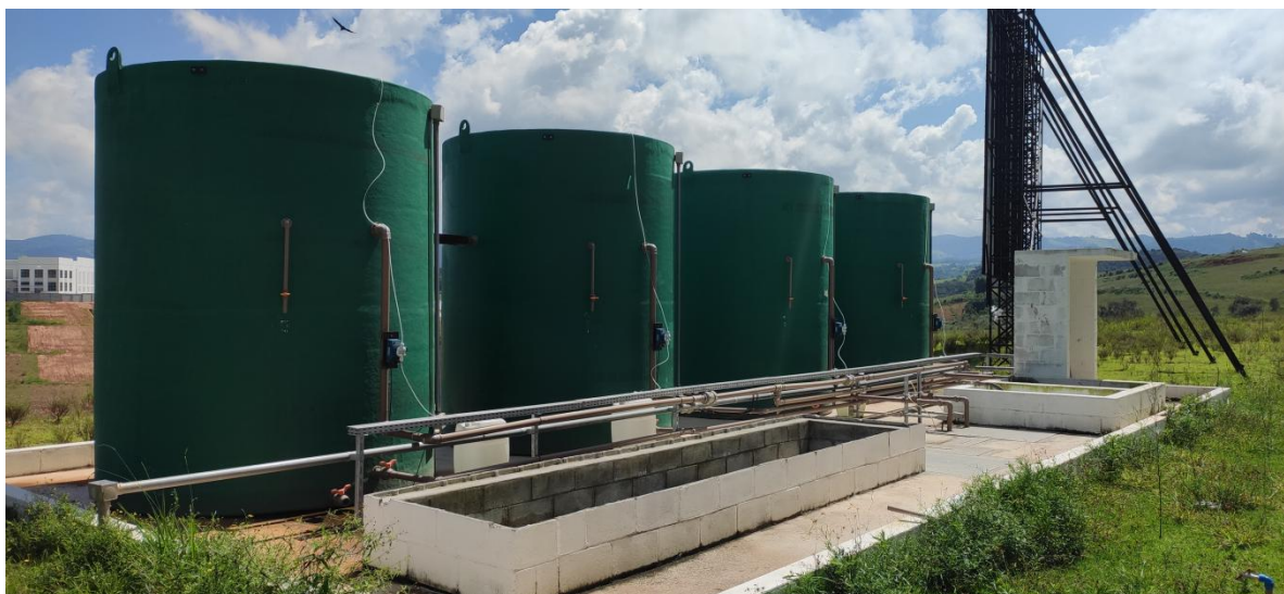
Figura 15. Estação de tratamento de esgoto
