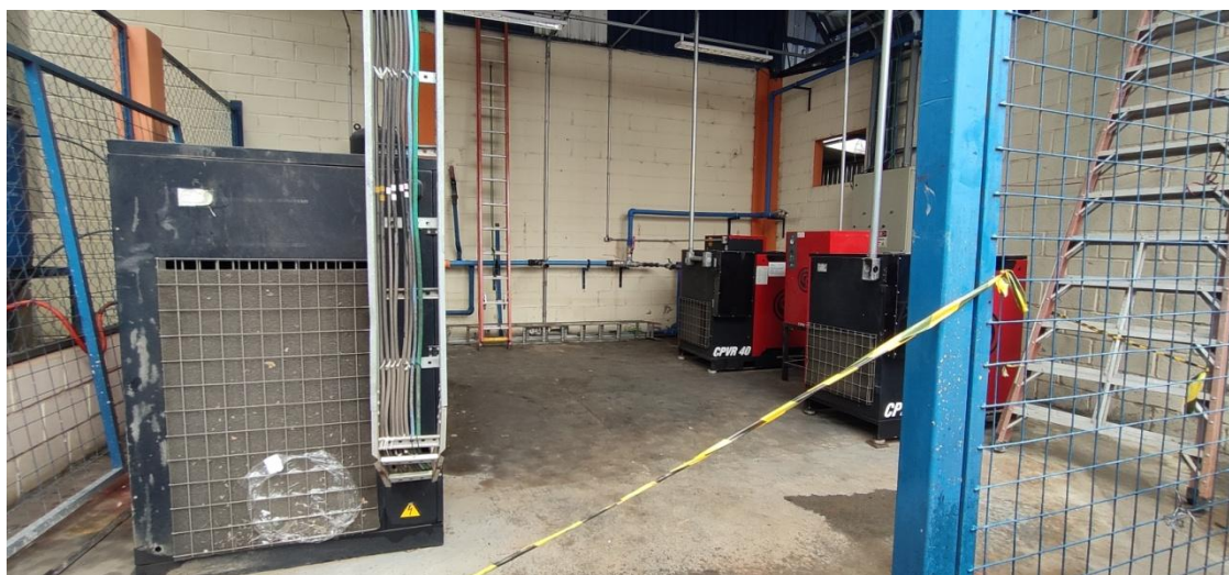
Figura 14. Área de compressores, com espaço para inclusão do 4º compressor. Fonte: SMA
