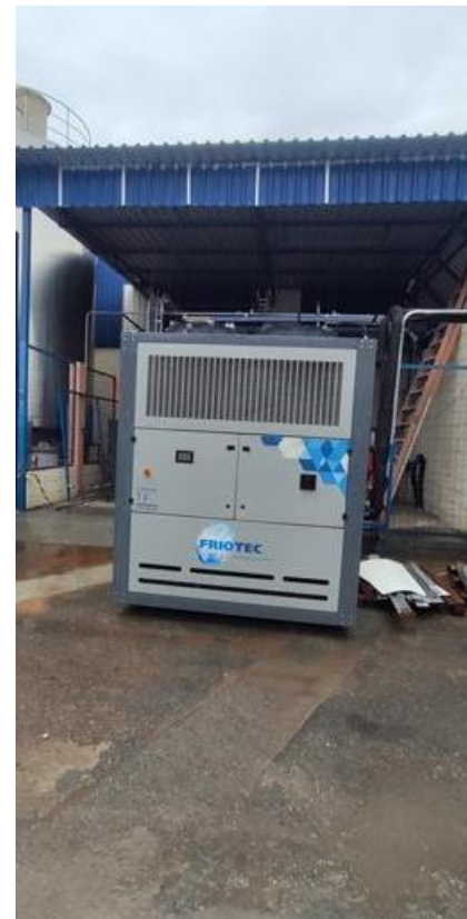
Figura 13. Chiller utilizado para suporte à ampliação. Fonte: SMA
