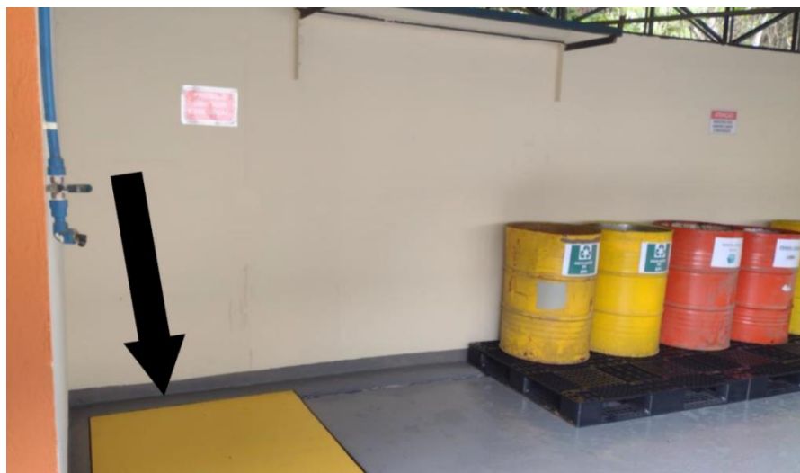
Figura 27. Área de armazenamento de Resíduos Classe I – com sistema canaleta e de contenção. Fonte: Empresa
