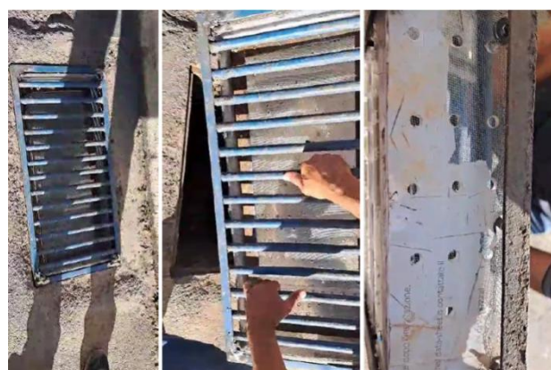
Figura 22. Sistema de contenção galerias pluviais. Fonte: SMA
