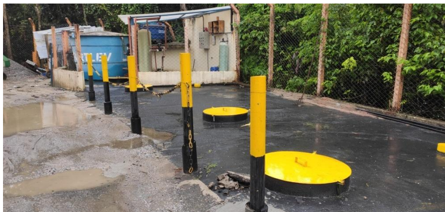
Figura 29. Sistema de tratamento de efluentes sanitários do empreendimento.
