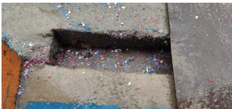
Figura 19. Canaleta de drenagem com pedaços plásticos na frente da saída da sala de moinho. Fonte: SMA
