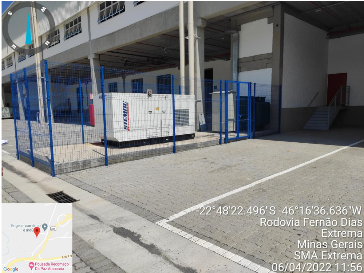
Figura 17. Gerador a diesel para abastecer o galpão em caso de queda de energia.
