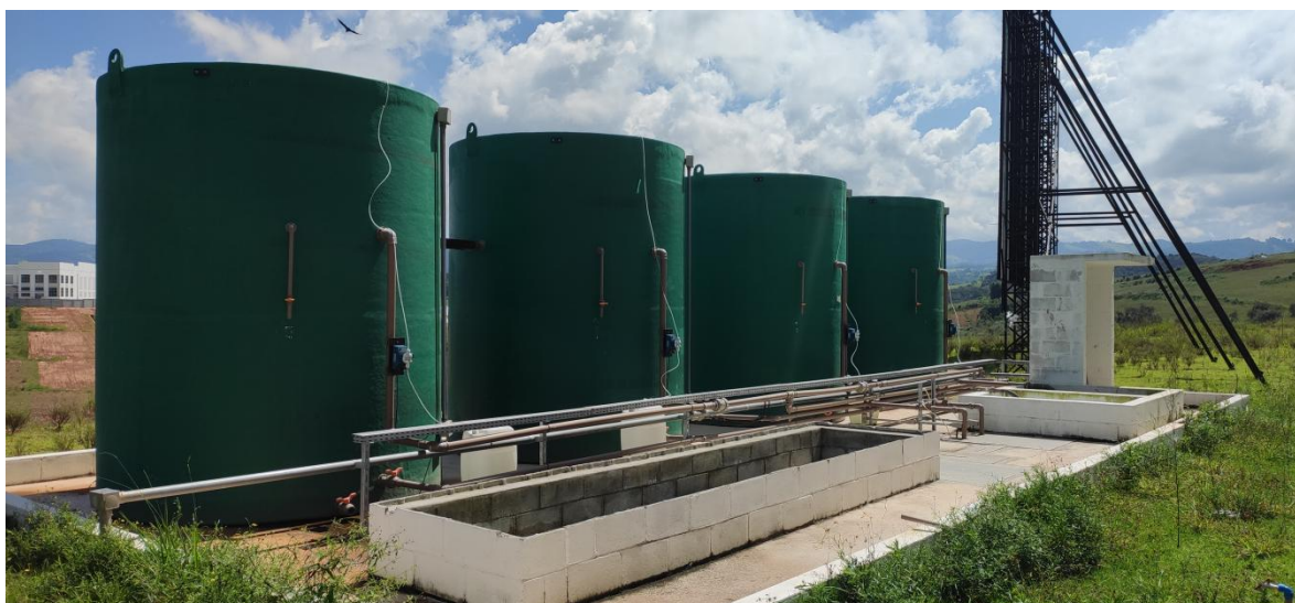
Figura 16. Estação de tratamento de esgoto.
