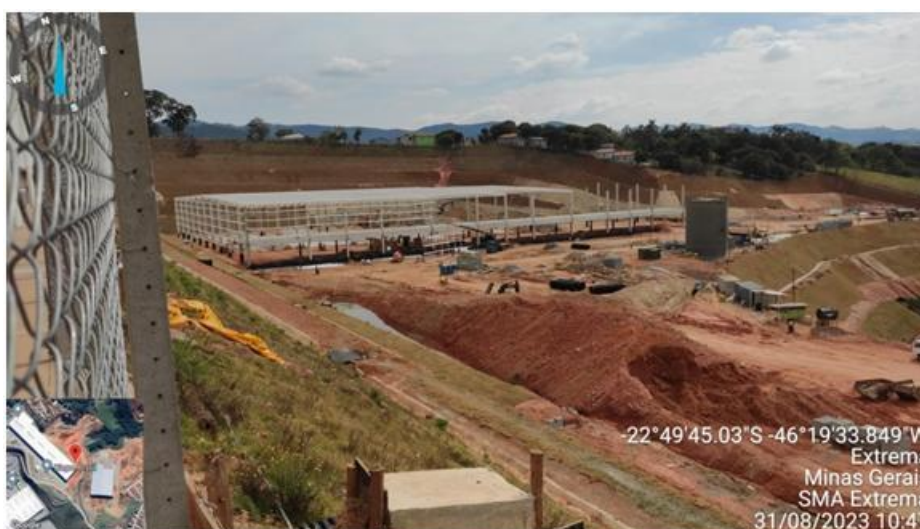
Figura 19. Lançamento provisório de águas pluviais dos taludes de fundo do G100 (galpão utilizado pelo empreendimento), enquanto finalizam execução do sistema de drenagem.
