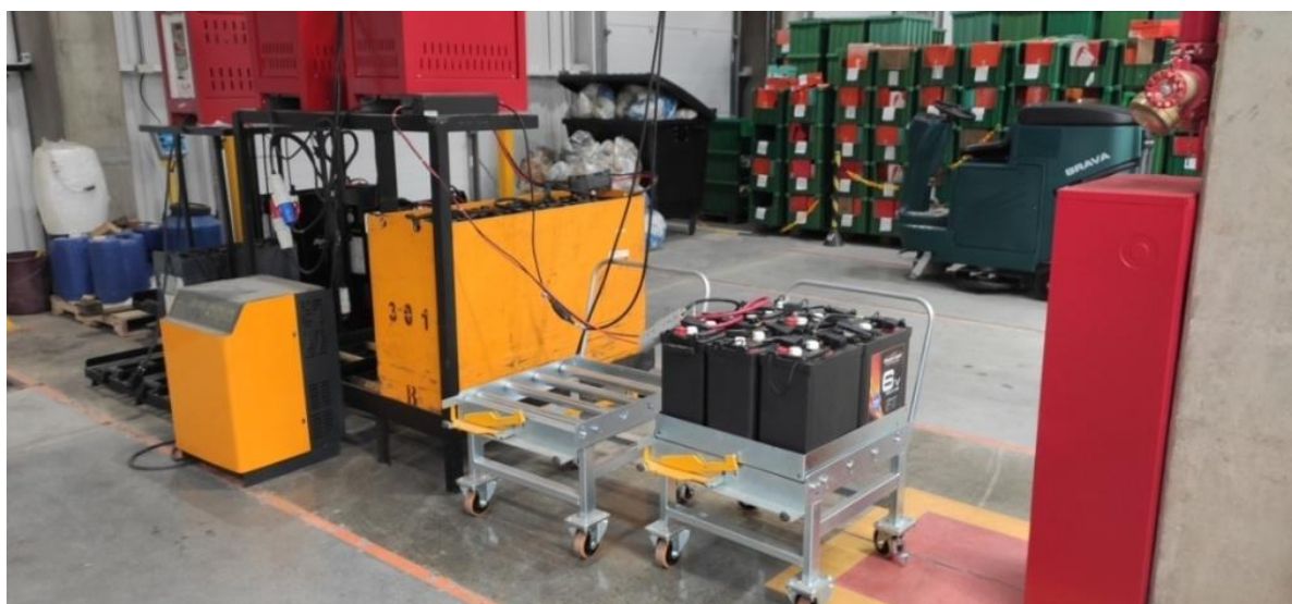
Figura 12. Área de recarga de empilhadeiras.
