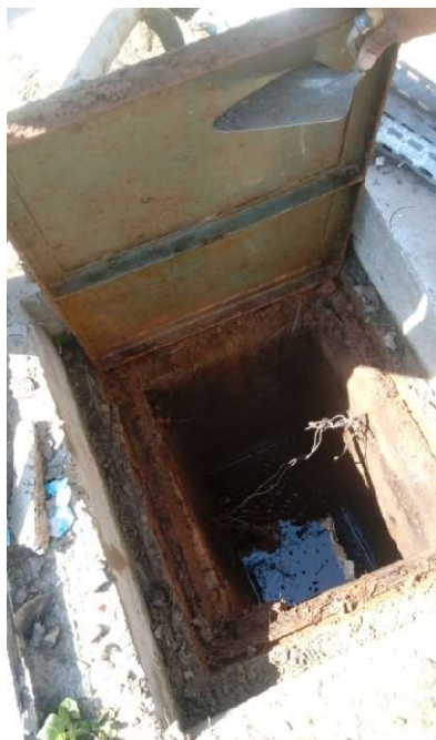
Figura 16. Entrada do sistema de tratamento de efluentes sanitários
