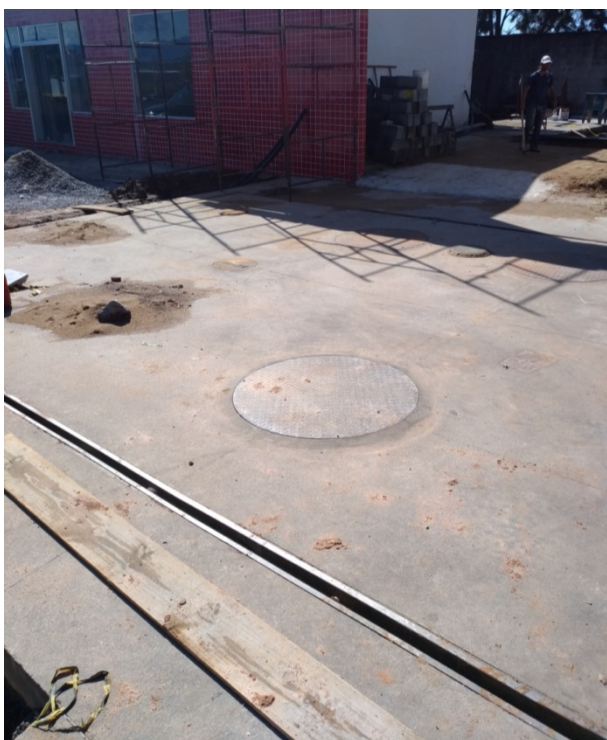
Figura 4. Área de descarga e localização dos tanques subterrâneos de combustíveis
