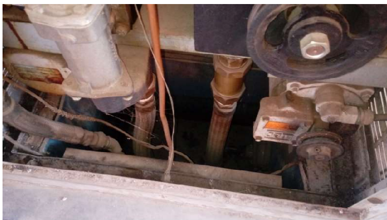
Figura 14. Sistema de contenção de vazamentos da bomba do SASC
