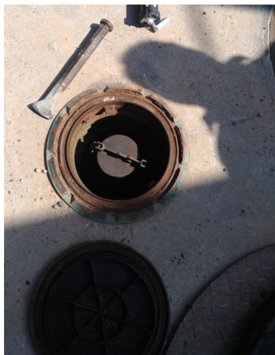
Figura 13. Boca de abastecimento de combustível do tanque
