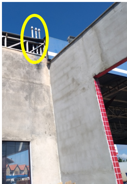
7. Tubulação de respiro dos tanques já instalados do SASC
