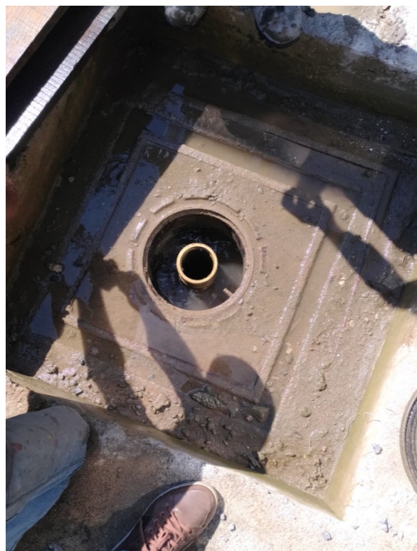
Figura 11. Entrada de sucção do tanque de armazenamento subterrâneo de óleo usado
