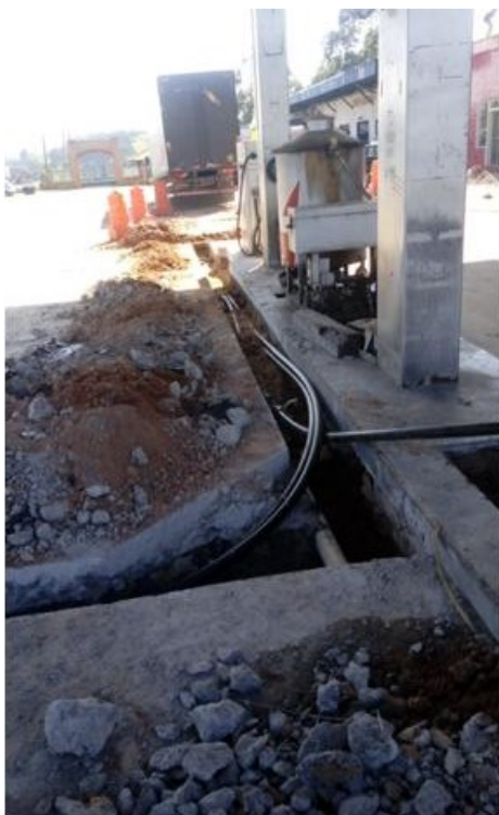
Figura 6. Instalação das linhas de abastecimento do novo tanque e unidades de abastecimento do SASC
