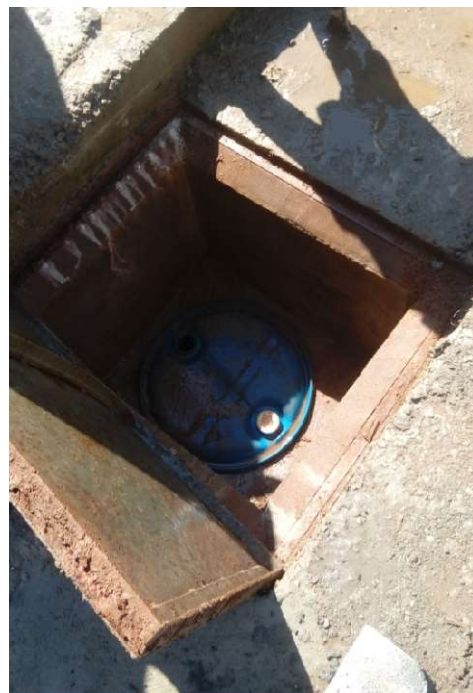
Figura 9. Caixa de Passagem do Sistema SAO
