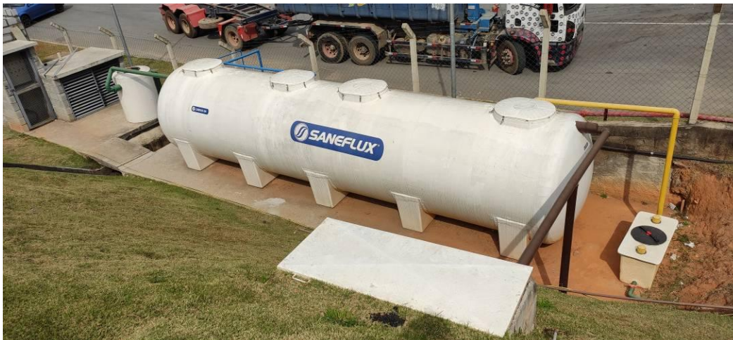
Figura 12. Sistema de tratamento de Efluentes Sanitários que atende ao condomínio logístico
