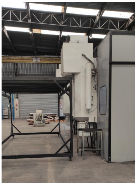
Figura 15. Sistema exaustor da cabine de pintura.
