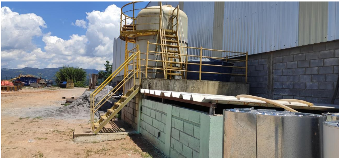
Figura 22. Estação de tratamento de efluentes industriais.
