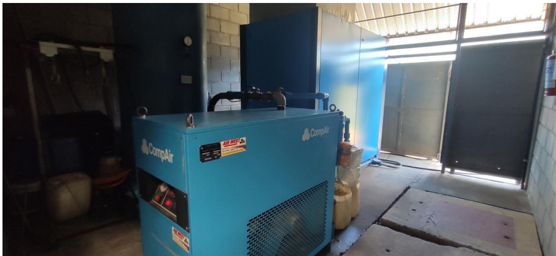
Figura 20. Sala dos compressores.
