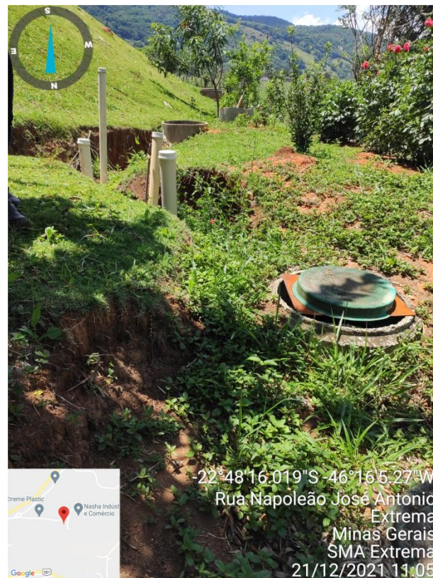
Figura 24. Sistema de tratamento de efluentes sanitários
