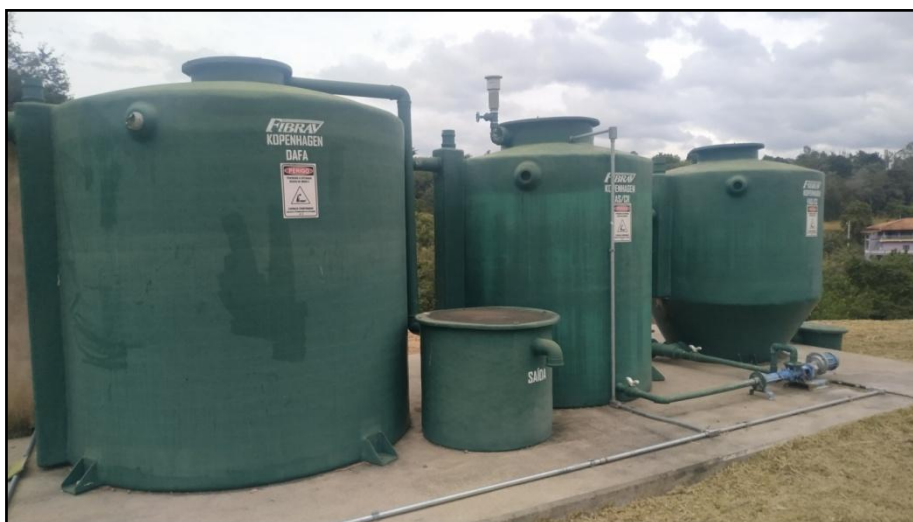
Figura 4. Sistema de tratamento de efluentes sanitários.
