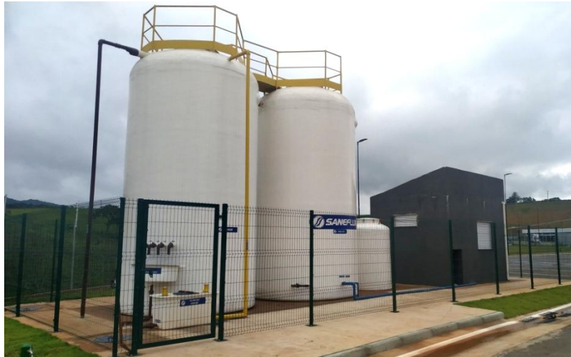
Figura 6. Estação de Tratamento de Efluentes
