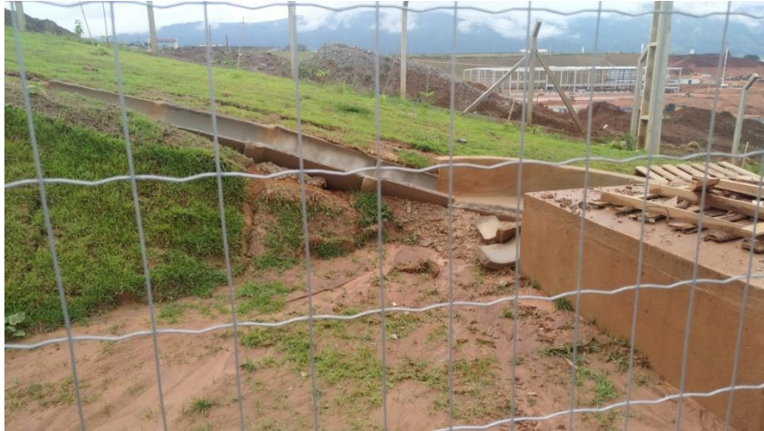
Figura 11. Caixa de passagem CPt 112, com evidências de extravasamento e carreamento de solo, em 18/03/2020
