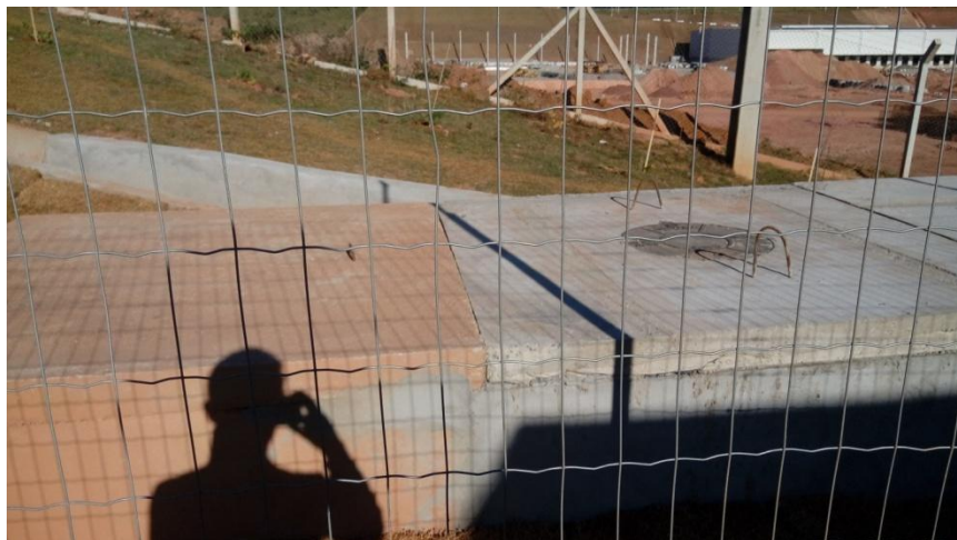
Figura 12. Caixa de passagem CPt 112, com evidências de execução de adequações
