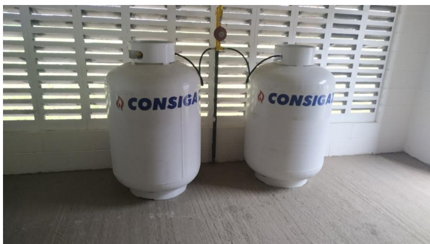
Figura 6. Área de armazenamento de GLP para uso na cozinha do refeitório
