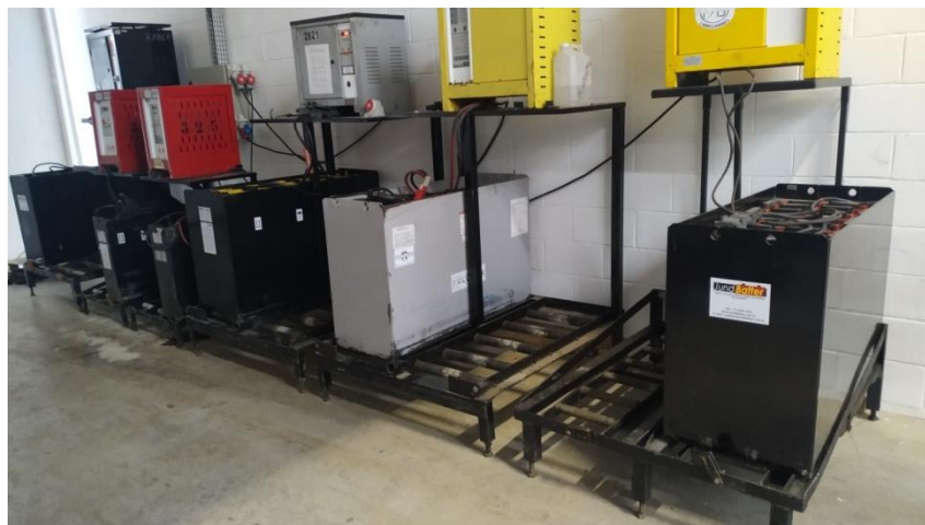
Figura 5. Sala de carregamento de baterias
