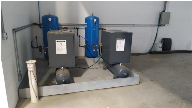
Figura 4. Localização dos equipamentos de compressão de ar, com bacia de contenção para prevenção em caso de vazamentos.
