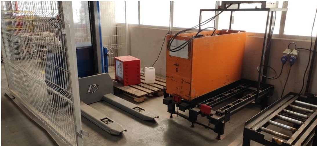
Figura 4. Área delimitada de carregamento de baterias
