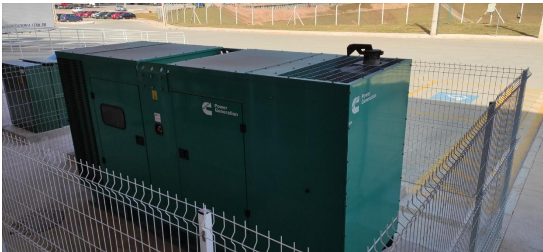
Figura 5. Área de uso de geradores, utiliza diesel como combustível.
