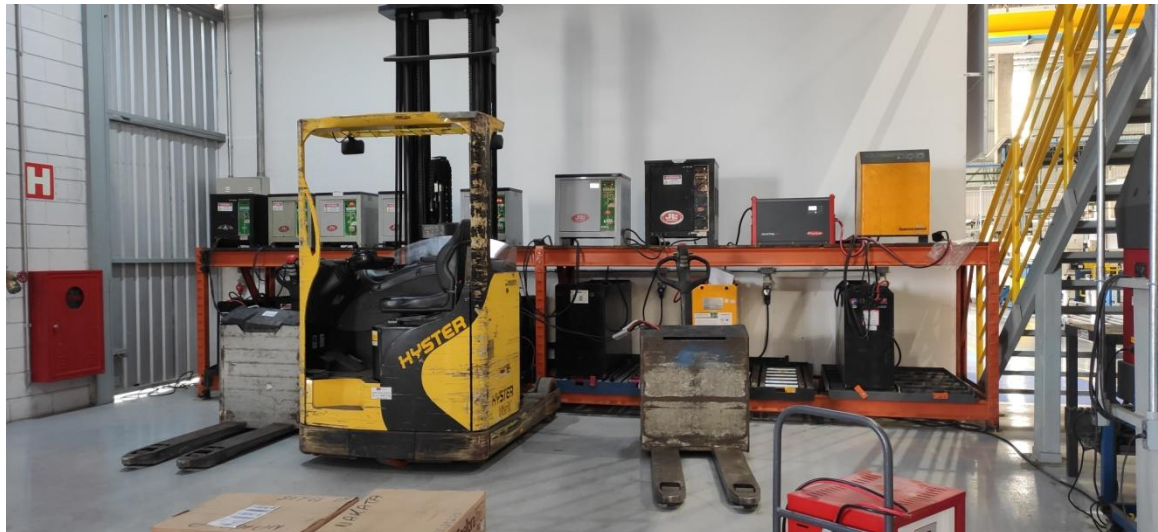
Figura 13. Área de recarga de bateria das empilhadeiras.
