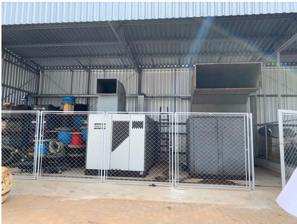
Figura 22. Área dos compressores.
