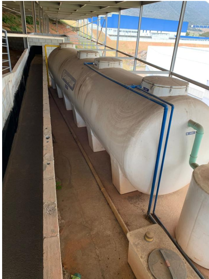
Figura 27. Estação de tratamento de efluentes sanitários da área fabril.
