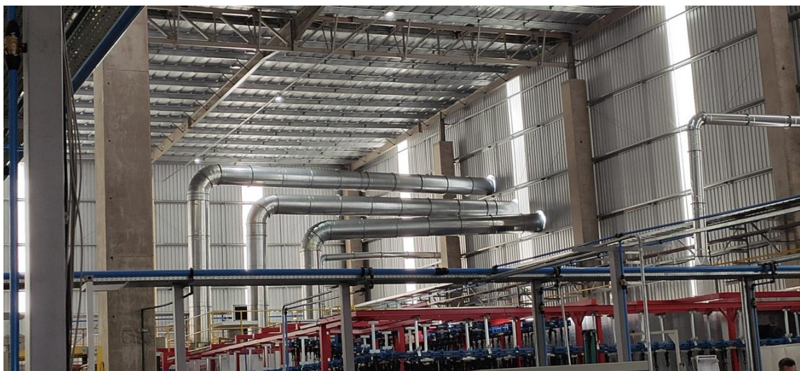
Figura 20. Sistema de exaustão da linha de pintura e estufa de secagem.
