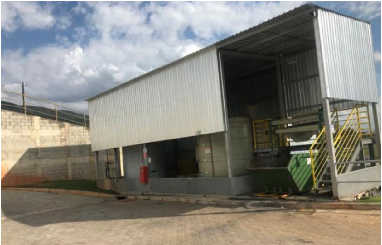
Figura 26. Estação de tratamento de efluentes industriais após finalização da instalação (Fonte: Relatório empreendedor).
