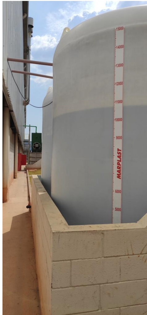
Figura 19. Tanques de armazenamento temporário de efluentes industriais.
