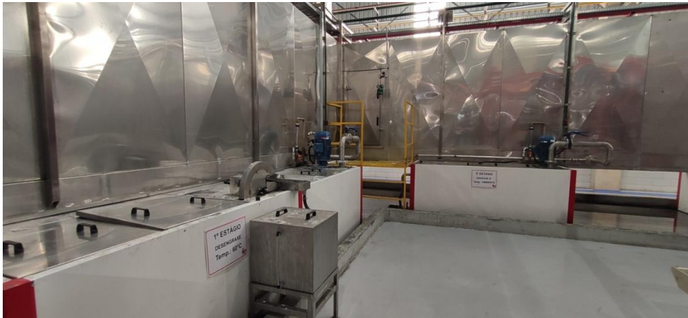
Figura 6. Sistema pré-tratamento de peças para pintura.
