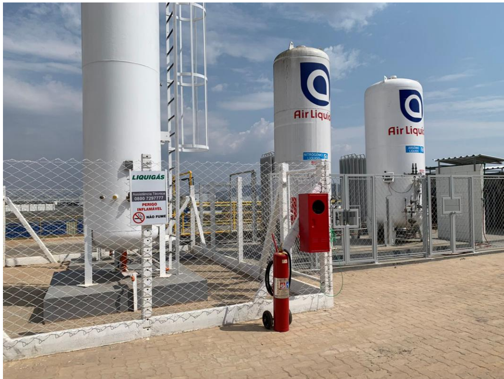
Figura 23. Local de armazenamento de gases GLP, argônio e nitrogênio.
