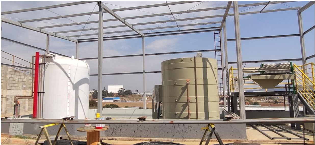
Figura 25. Estação de tratamento de efluentes industriais (em instalação).
