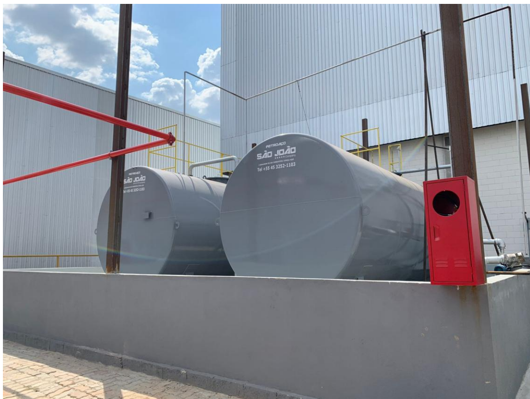
Figura 24. Tanques de armazenamento de óleo hidráulico/lubrificante.
