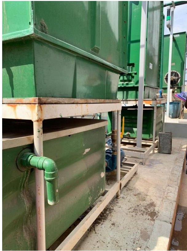
Figura 21. Sistemas de Resfriamento/refrigeração.
