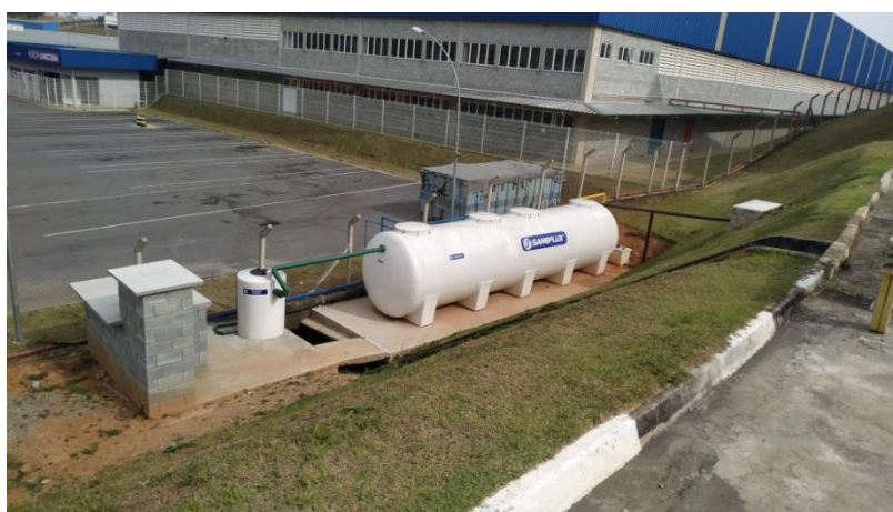
Figura 5. Estação de Tratamento de Efluentes (ETE) do Condomínio Extremo Sul.
