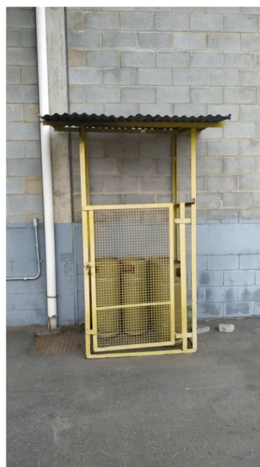
Figura 7. Central de armazenamento de GLP.
