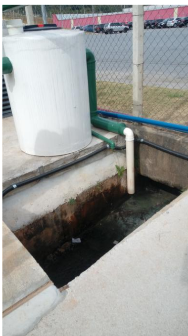
Figura 6. Saída de efluente tratado da ETE.
