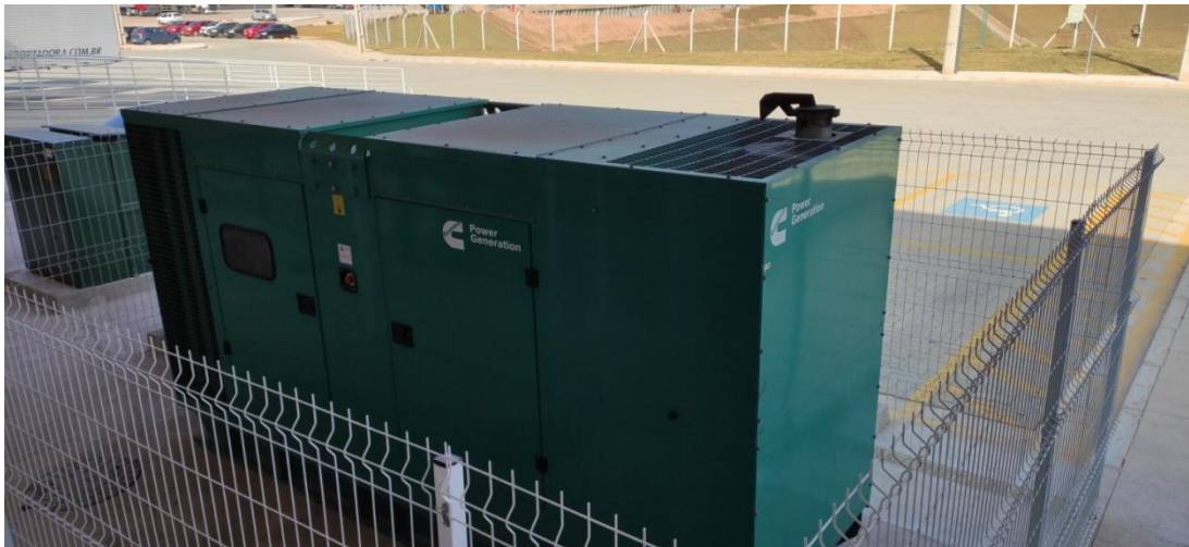
Figura 7. Área de uso de geradores, utiliza diesel como combustível.
