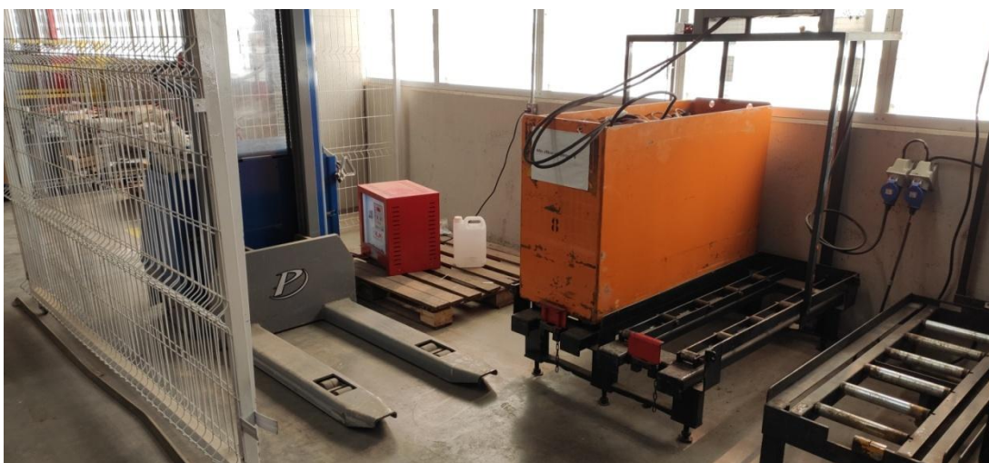
Figura 5. Área delimitada de carregamento de baterias
