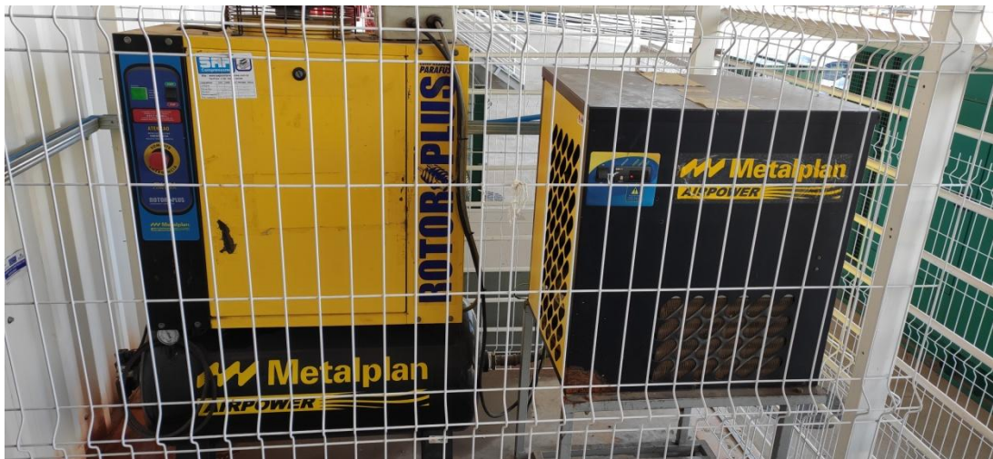
Figura 8. Área de uso de compressor
