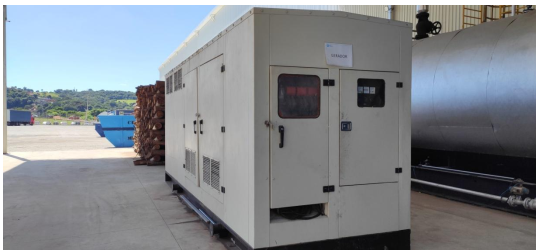
Figura 22. Gerador que será utilizado na operação do empreendimento.
