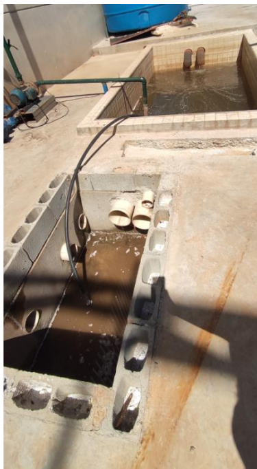
Figura 19. Tanque de recepção e de retorno da água utilizada na caldeira.
