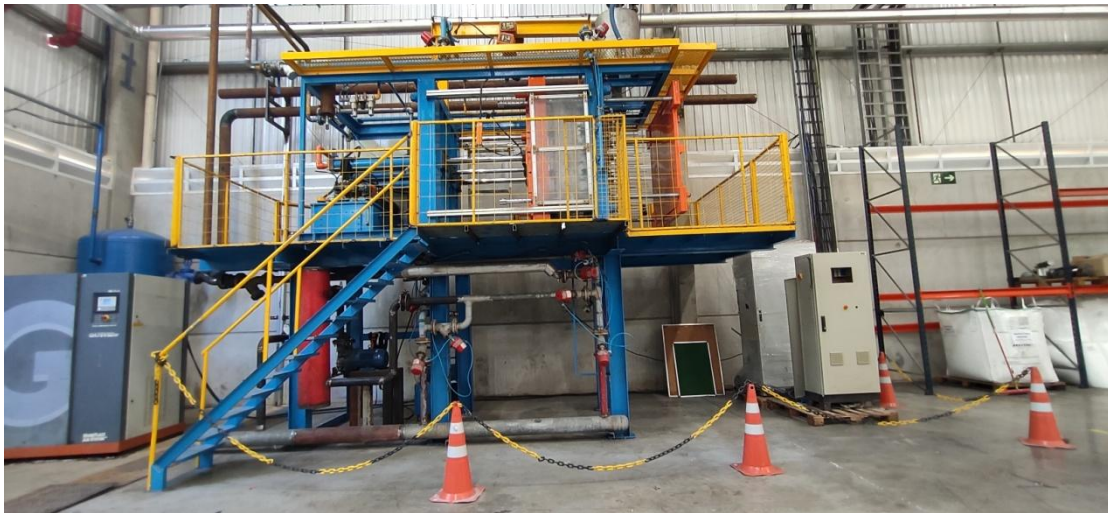
Figura 12. Equipamento para moldagem automática de caixas, ainda não finalizada instalação.
