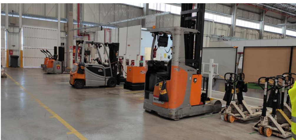
Figura 3. Área de carregamento de baterias
