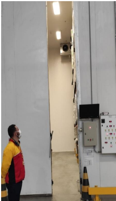
Figura 5. Câmera refrigerada para estoque de champagnes
