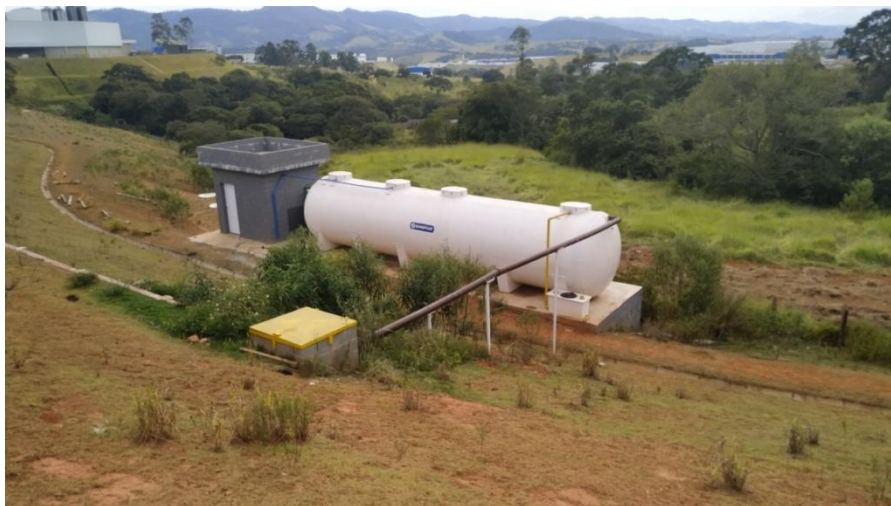
Figura 5. Estação de Tratamento de Efluentes
