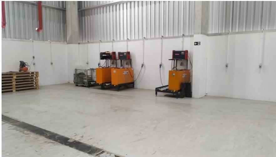
Figura 4. Local de carregamento de baterias, com grelha de contenção e piso impermeável
