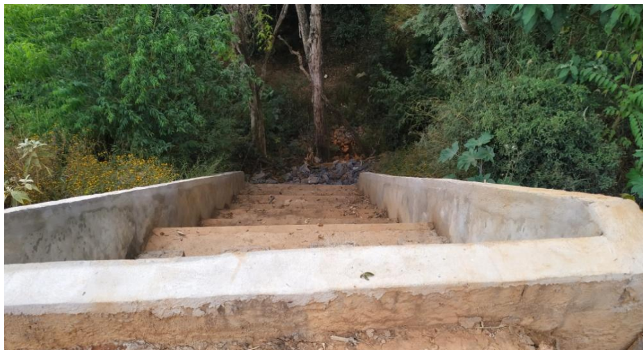
Figura 10. Escada hidráulica para lançamento do volume sobressalente da captação de águas pluviais
