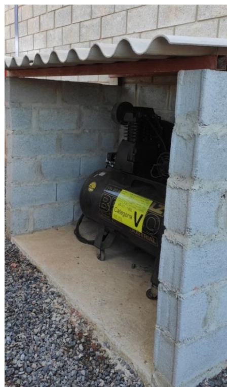
Figura 12. Local do compressor antes das adequações.
