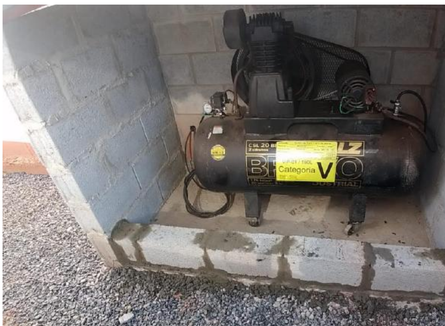
Figura 13. Sistema de contenção do compressor, conforme apresentado pelo empreendedor na data de 21/07/2021.
