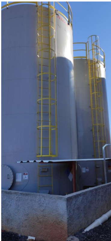
Figura 4. Tanques de armazenamento de produtos.
