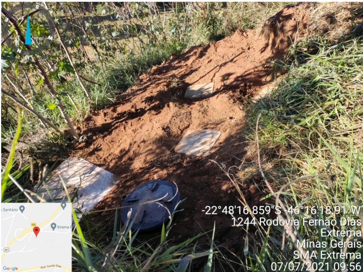
Figura 18. Sistema de tratamento de efluentes (biodigestor) e sumidouros
