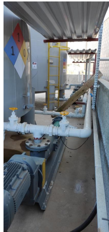
Figura 5. Tubulação de abastecimento da envasadora.
