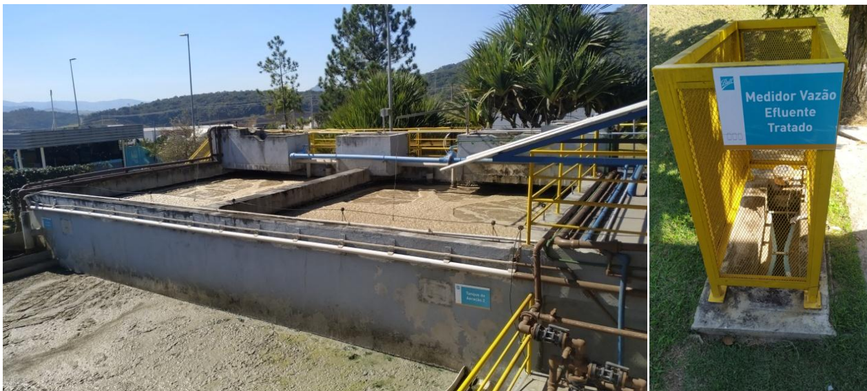
Figura 21. Módulos de aeração e decantação e medidor de vazão de efluente na saída da ETE Biológica.
