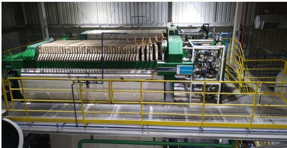
Figura 18. Filtros-prensas da ETE Físico-Química.
