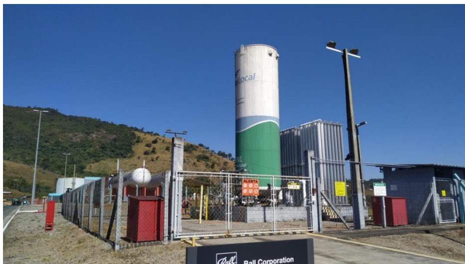
Figura 23. Central de armazenamento de combustível GNL e GLP (GLP está desativado).
