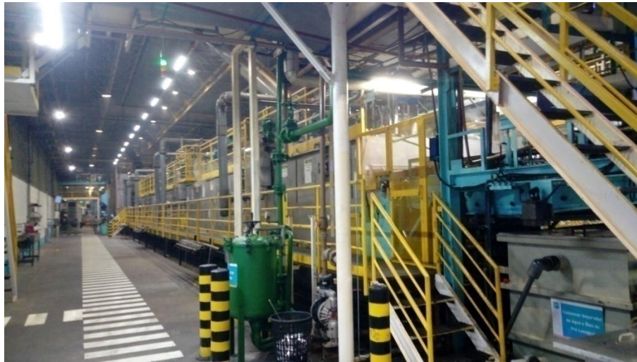
Figura 4. Vista lateral de uma das lavadoras instaladas.
