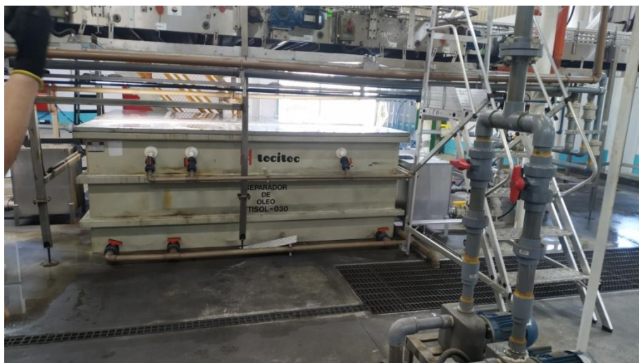
Figura 14. Separador de óleo na recepção do efluente na ETE Físico-Química.
