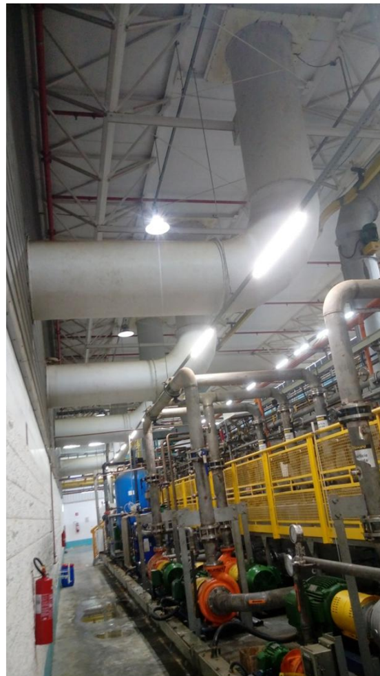
Figura 5. Vista lateral de uma das lavadoras instaladas, com destaque para tubulações de exaustão e refrigeração.
