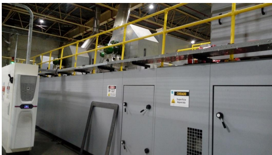
Figura 7. Vista parcial de um dos fornos de secagem.
