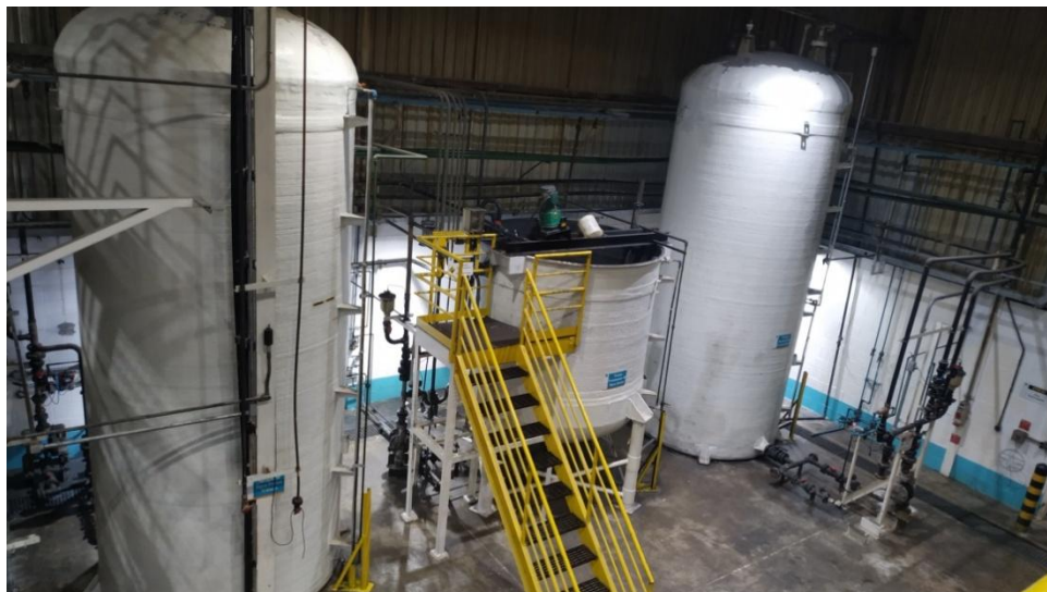
Figura 17. Tanques do sistema de tratamento de água oleosa (da direita para esquerda: recebimento, tratamento e armazenamento de água tratada).
