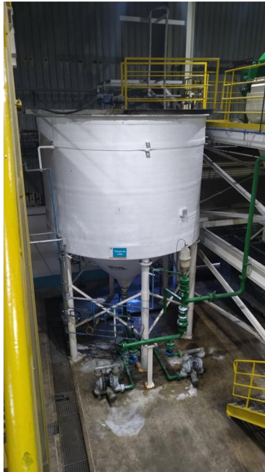
Figura 19. Tanque de acúmulo de lodo da ETE Físico-Química.
