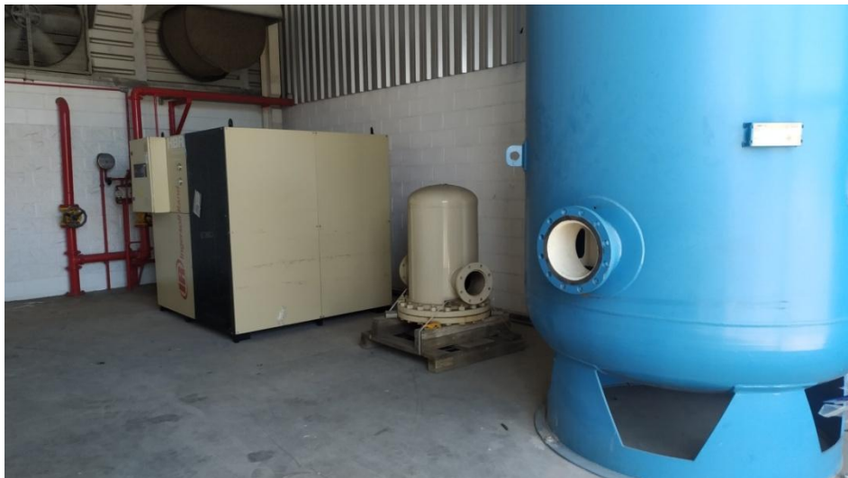
Figura 12. Vista parcial da ampliação da área de compressores.
