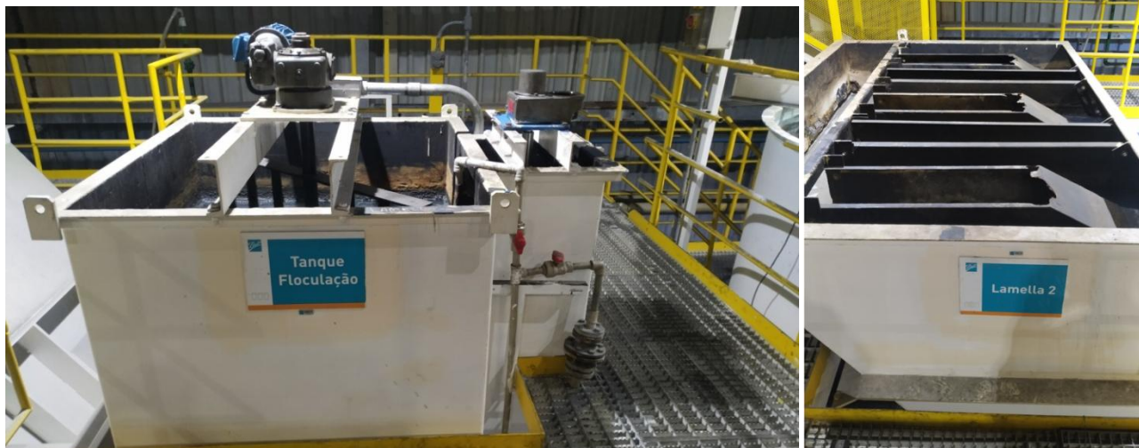
Figura 16. Tanque de Floculação 2 e Lamella 2 da ETE Físico-Química.
