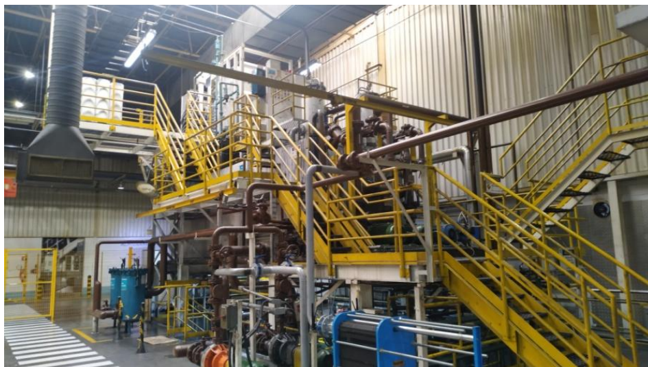
Figura 13. Sistema de filtragem para reaproveitamento do óleo solúvel.
