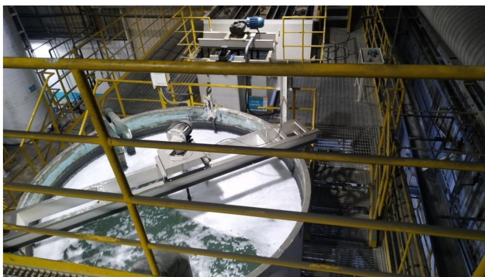
Figura 14. Visto superior do Tanque de neutralização secundária, Tanque de flocação 2 e Lamella 2.
