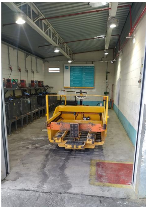
Figura 22. Sala de carregamento de baterias.
