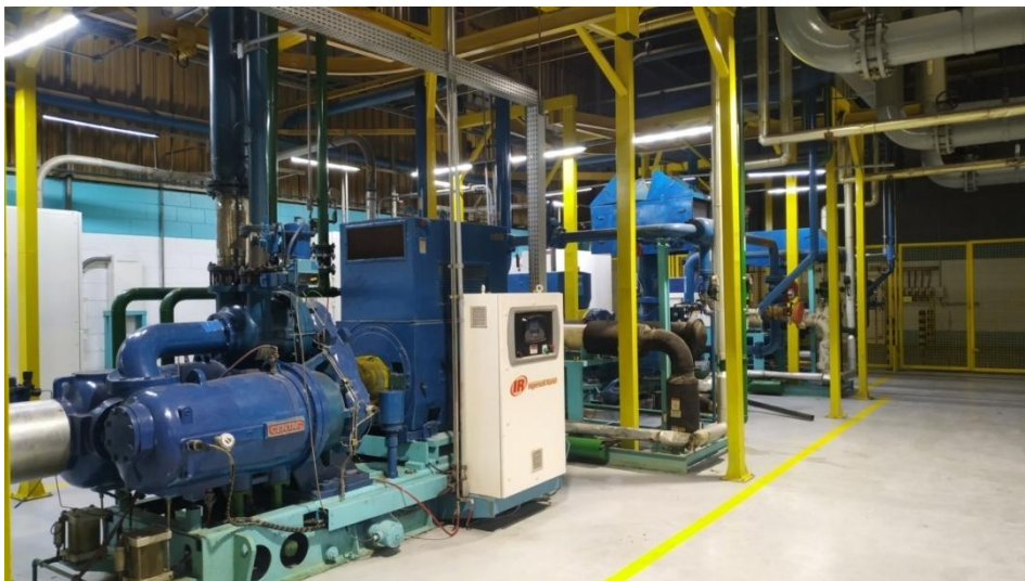
Figura 11. Vista parcial da área de compressores.
