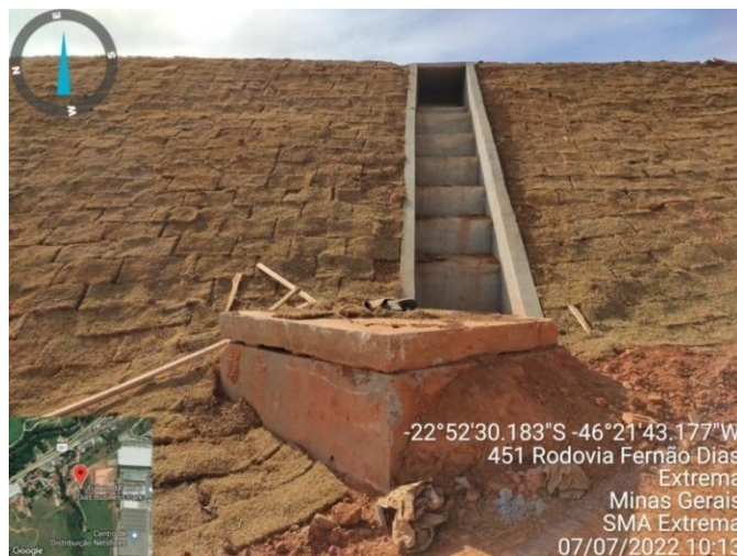
Figura 10. Escada hidráulica após saída do tanque de contenção 2.
