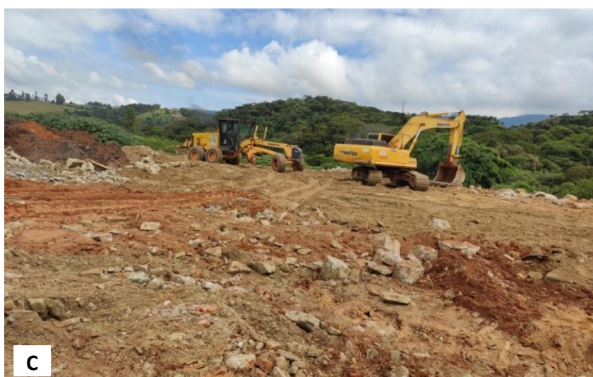
Figura 4. Registros (A), (B) e (C) de depósito de solo (e outros materiais de construção civil), e execução de terraplenagem na área aos fundos do terreno do empreendimento.
