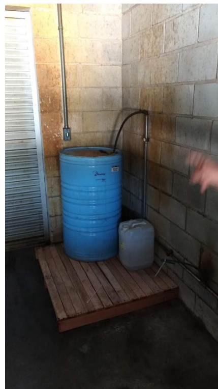
Figura 7. Local armazenamento água de purga.
