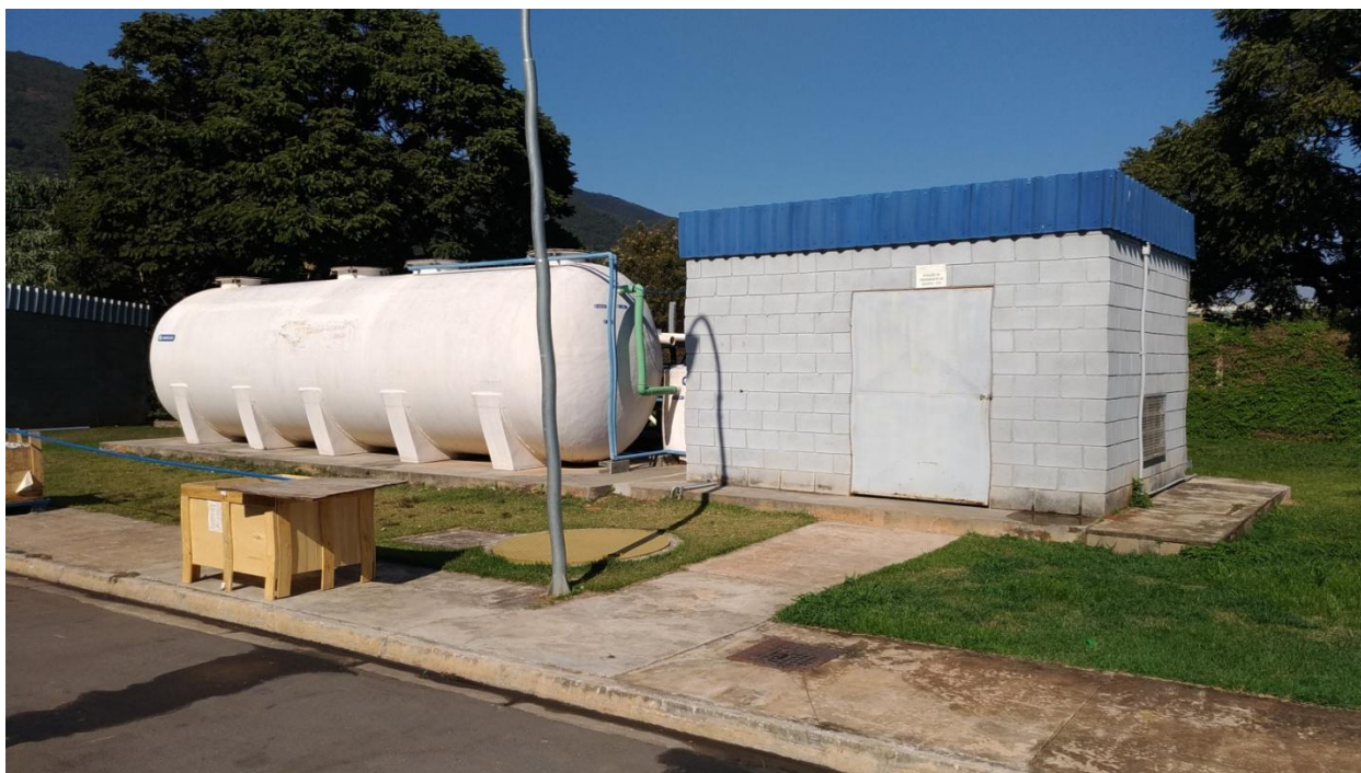
Figura 10. Sistema de Tratamento de Efluentes Saneflux.
