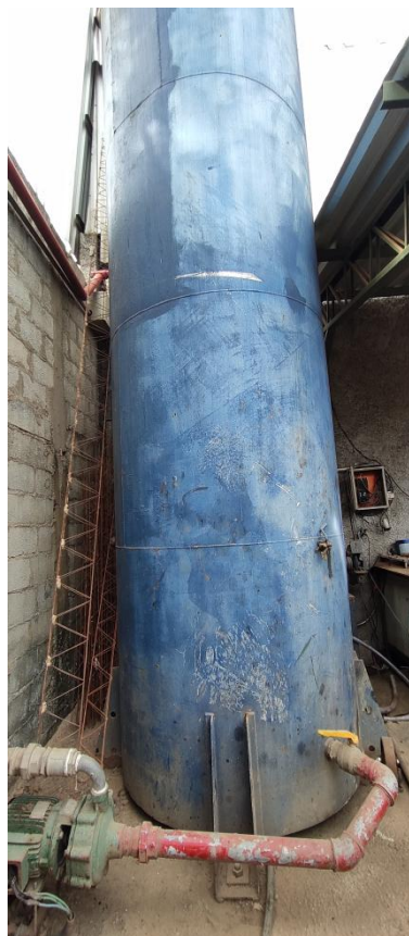
Figura 11. Caixa d'água para atendimento ao sistema de combate a incêndio.
