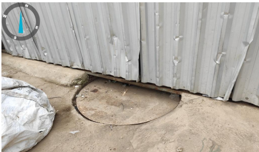
Figura 13. Tapa de acesso ao sistema exclusivo de tratamento de esgoto sanitário
