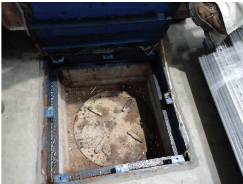
Figura 6. Entrada Fossa Séptica
