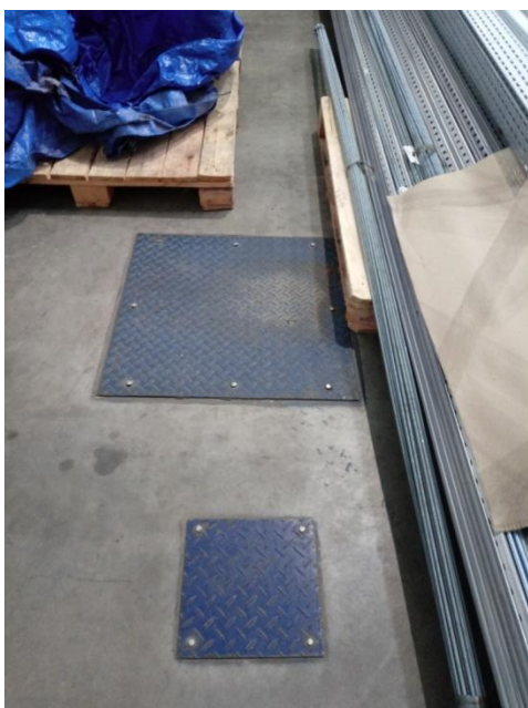
Figura 7. Local de acesso à entrada do filtro anaeróbio
